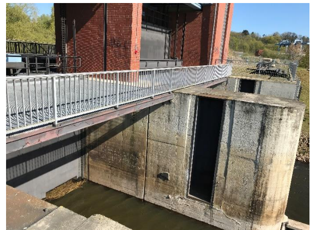
Abbildung 46: Potenzielle Quartiersstrukturen in Fugen der Bauwerkskonstruktion
