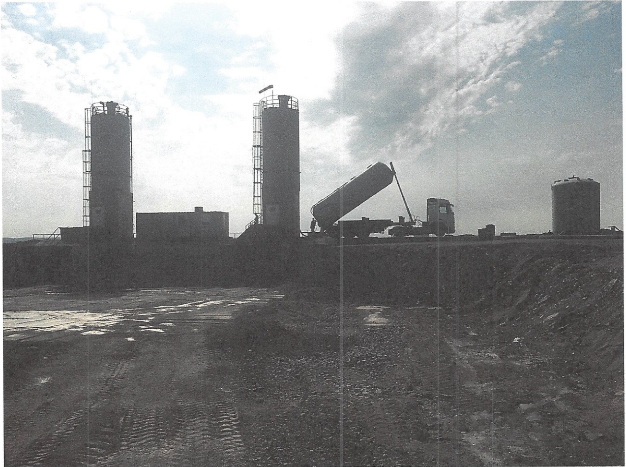
Abb. 1: Blick auf die umgesetzte Konditionierungsanlage für Aschen (September 2020)
