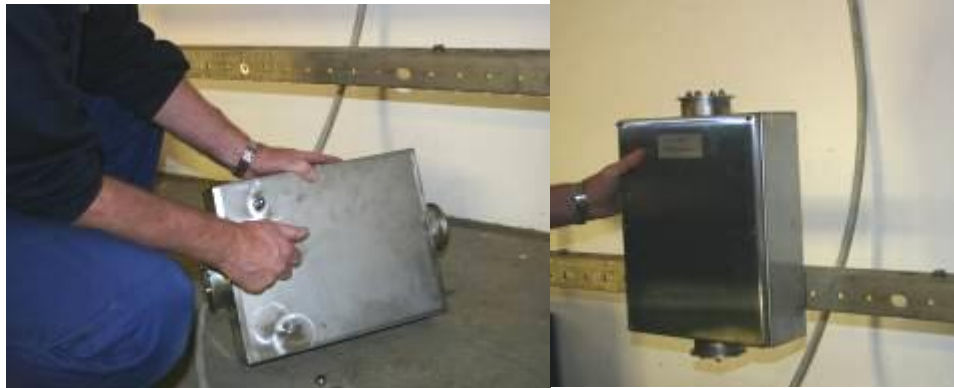
Abbildung 7-63: Installation des Potentialausgleichskastens an der Haupterdungsschiene
