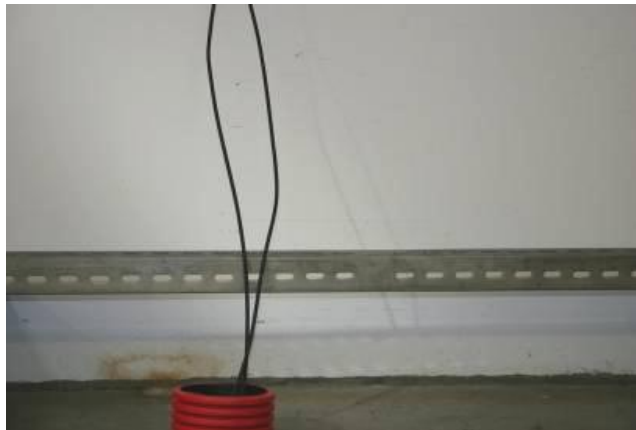
Abbildung 7-40: Kabel für Kommunikationsleitungen, die in die Windenergieanlage führen
