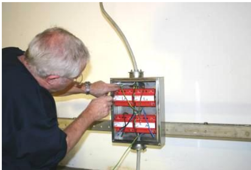
Abbildung 7-68: Anschluss der Leitungen an die Überspannungsableiter
