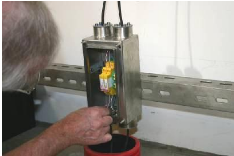
Abbildung 7-50: Anschluss der Leitungen an die Überspannungsableiter
