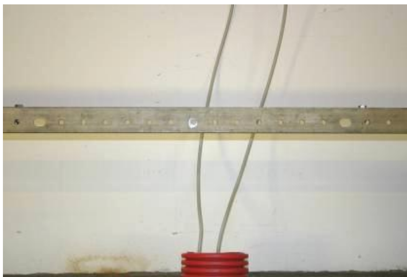
Abbildung 7-54: Kabel für den Meteorologie-Messmast, die in die Windenergieanlage führen
