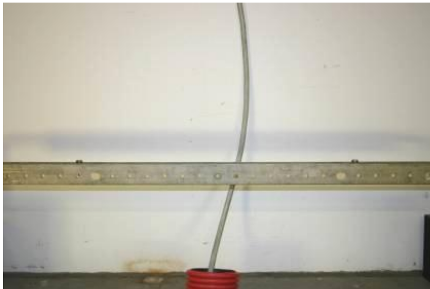
Abbildung 7-62: Kabel für externe Installationen, das in die Windenergieanlage führt
