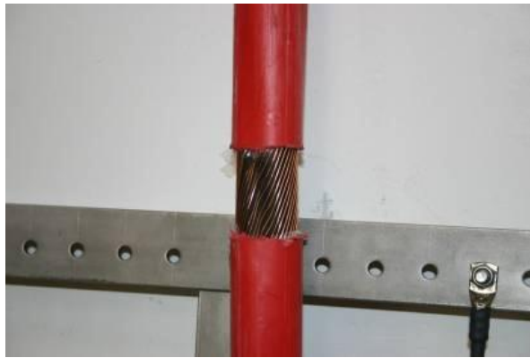
Abbildung 7-4: Hauptenergiekabel mit entfernter Kabelisolierung
