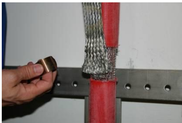
Abbildung 7-9: Am Kabel angebrachte Kupferlitze
