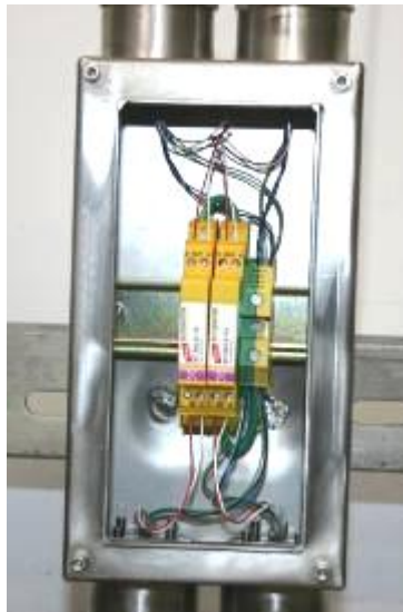
Abbildung 7-52: Ordnungsgemäßer Anschluss aller Leitungen
