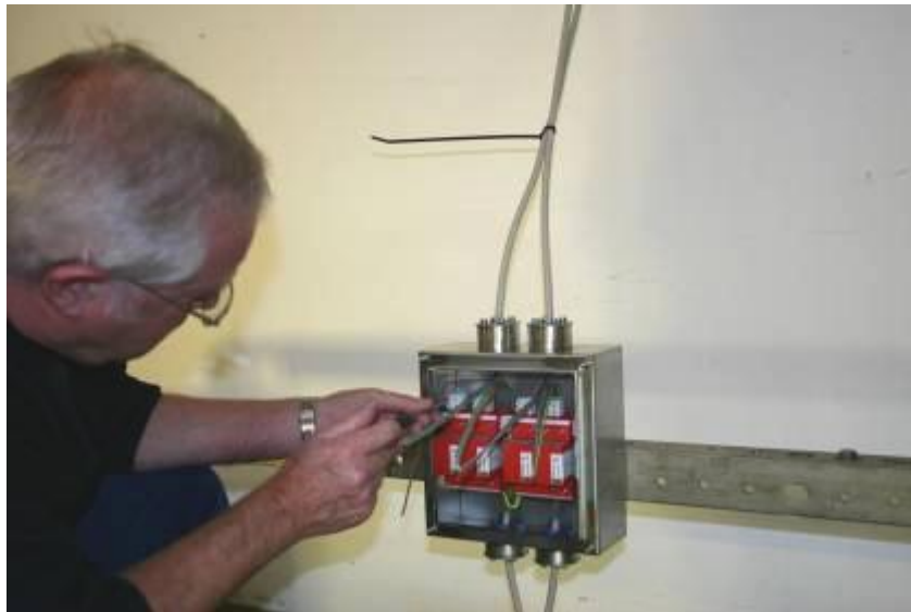
Abbildung 7-59: Anschluss der Leitungen an die Überspannungsableiter
