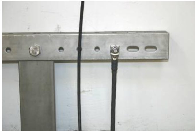
Abbildung 7-22: In die unterste Turmsection eingeführtes Kabel, das an der Haupterdungsschiene vorbeiläuft
