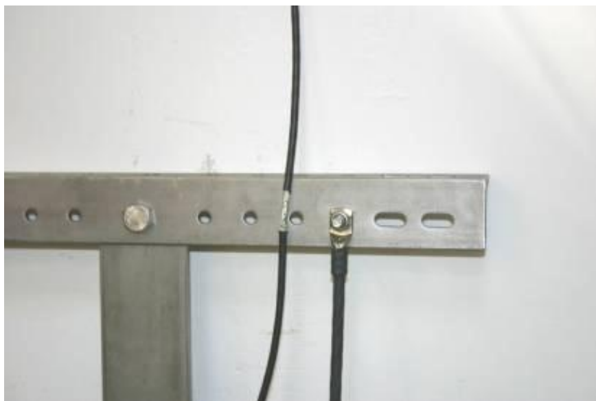
Abbildung 7-25: Die Außenisolierung des Kabels ist herausgeschnitten
