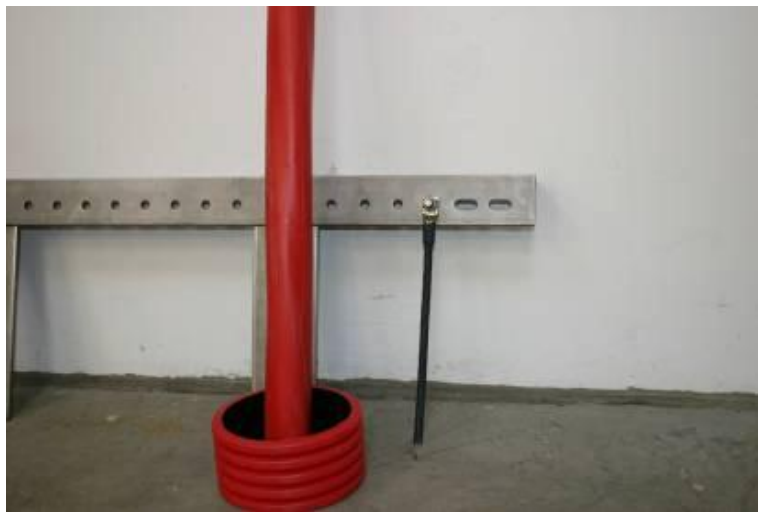
Abbildung 7-1: Mehradriges Hauptenergiekabel (Mittelspannung), das in den Turmsockel führt und an der Haupterdungsschiene vorbeiläuft
