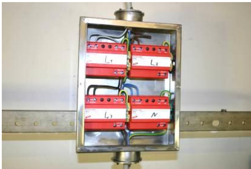
Abbildung 7-69: Ordnungsgemäßer Anschluss aller Leitungen
