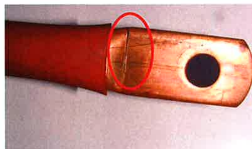
Abbildung 25-9: Riss in der Mittelspannungssammelschiene
