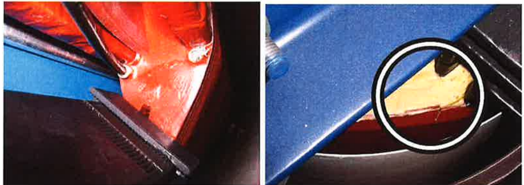
Abbildung 25–14: Risse an der Niederspannungswicklung
