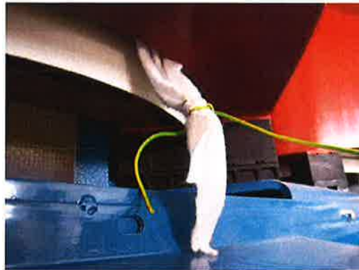
Abbildung 26–14: Die Mittelspannungswicklungen reinigen
