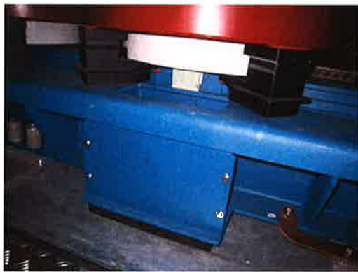
Abbildung 22–1: Lüftungskanal am Transformator
