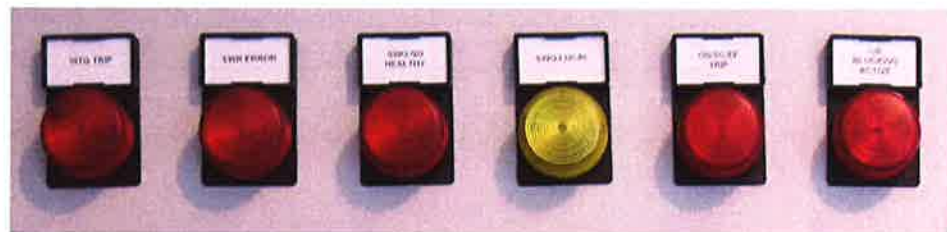
Abbildung 17–7: LEDs auf Ormazabal-Schaltanlagen
