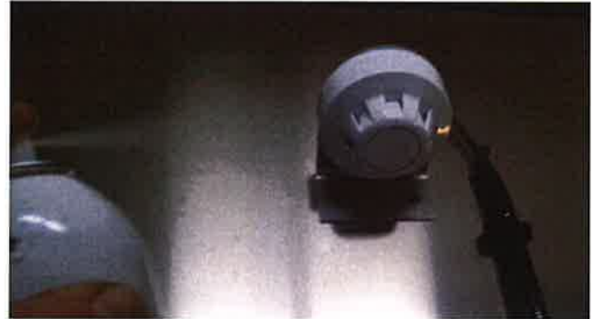
Abbildung 18–2: Rauchmelder an der Transformatorwand
