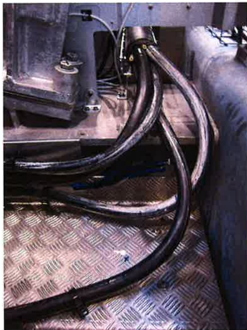
Abbildung 23-2: Einführung der Mittelspannungskabel in den Transformatorraum
