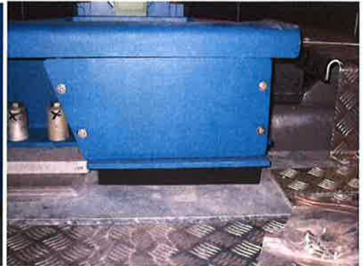
Abbildung 24-17: Abdeckplatte der Kühlluftkanäle
