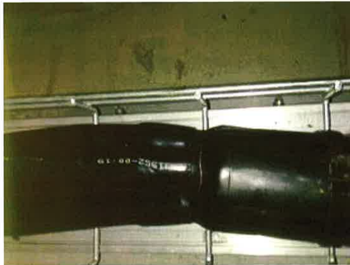
Abbildung 7-1: Risse im Schrumpfschlauch des Mittelspannungskabels.
