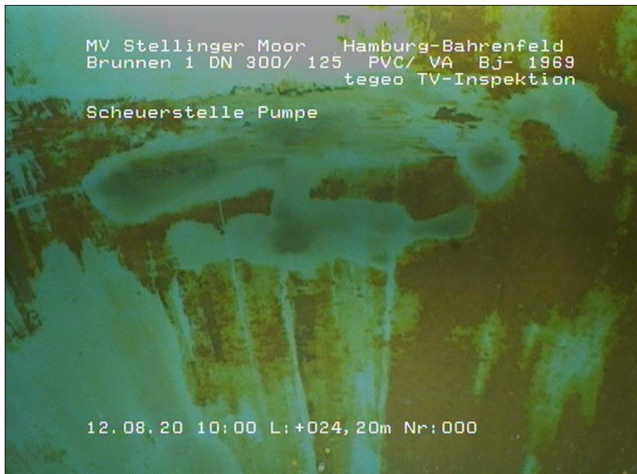
Foto: 1_8A 24,2m, Scheuerstelle Pumpe
