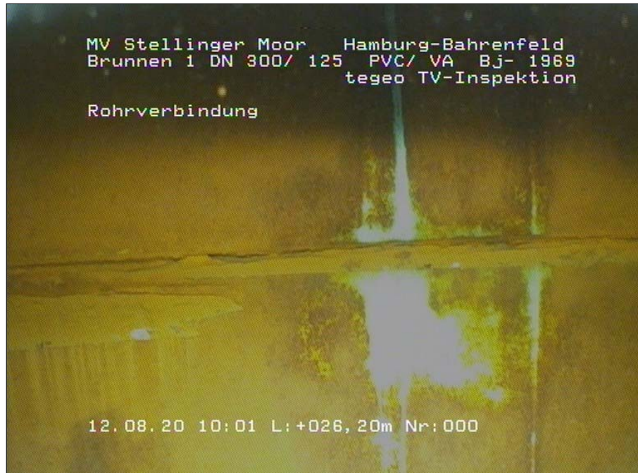
Foto: 1_9A 26,2m, Rohrverbindung
