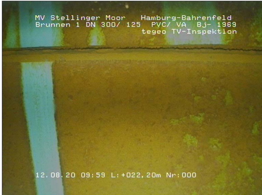
Foto: 1_7A 22,2m, Rohrverbindung
