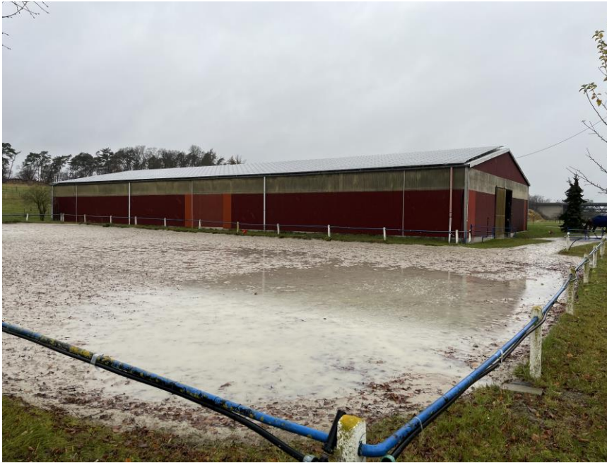
Abb. 17: Auf-Dach-Photovoltaikanlage der Reithalle
