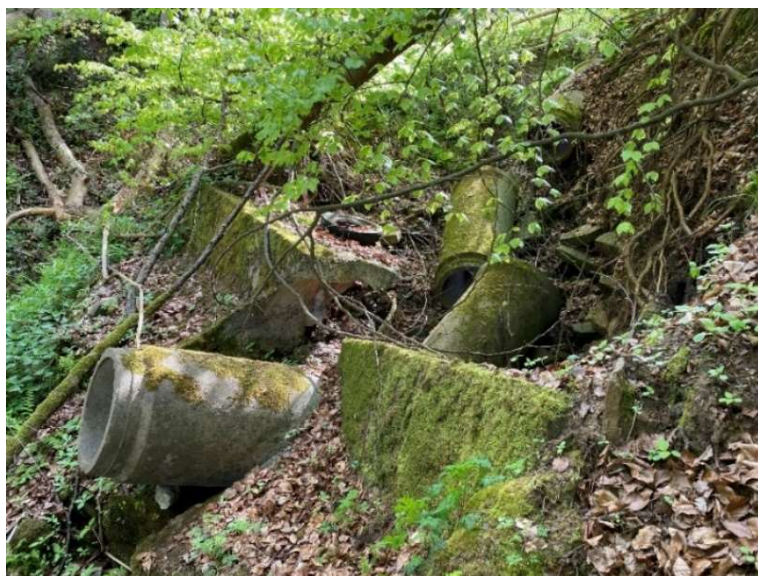
Abbildung 63: Abgerutschte und zerstörte Entwässerungseinrichtung im Bereich des „Namenlosen Bach“
