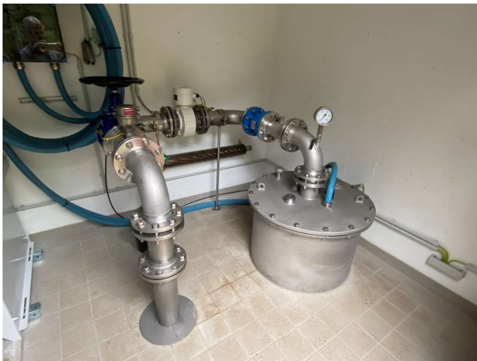
Abbildung 9: TB IV Wellerode
