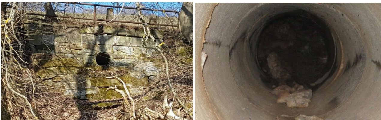
Abbildung 5.3: Stillgelegte Entwässerung der B7, rechts das teilweise verfüllte Rohr
