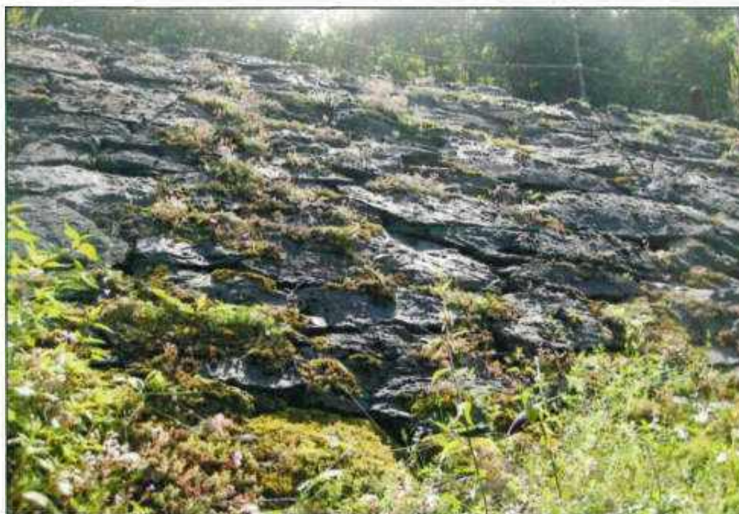
Abbildung 29: Mauervegetation an Bahnstützmauer
