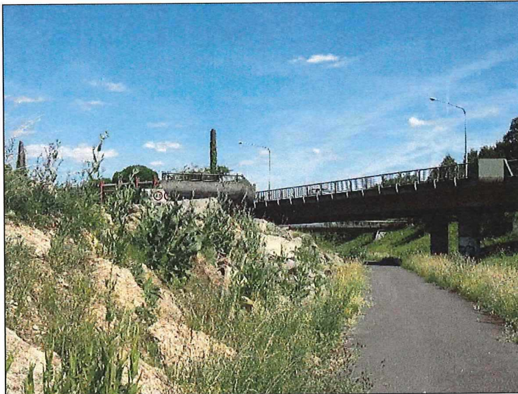
Foto 7: Abbruchmaterial mit Ruderalvegetation auf Höhe der Seckbachtalbrücke (Beil, 14.06.17).
