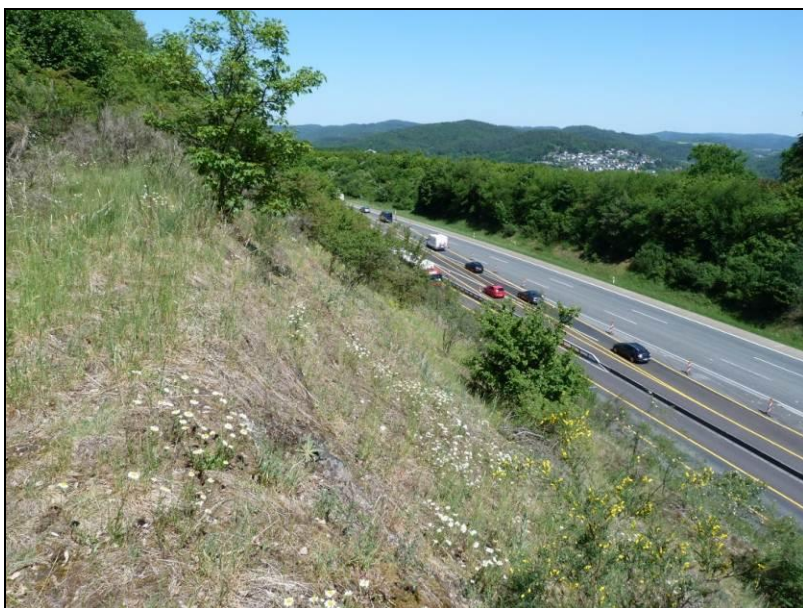
Abb. 13: Als Sukzession an künstlichen Gesteinsaufschlüssen (10.131) kartierte Hanganschnitte an der A 45 im Süden des UG
