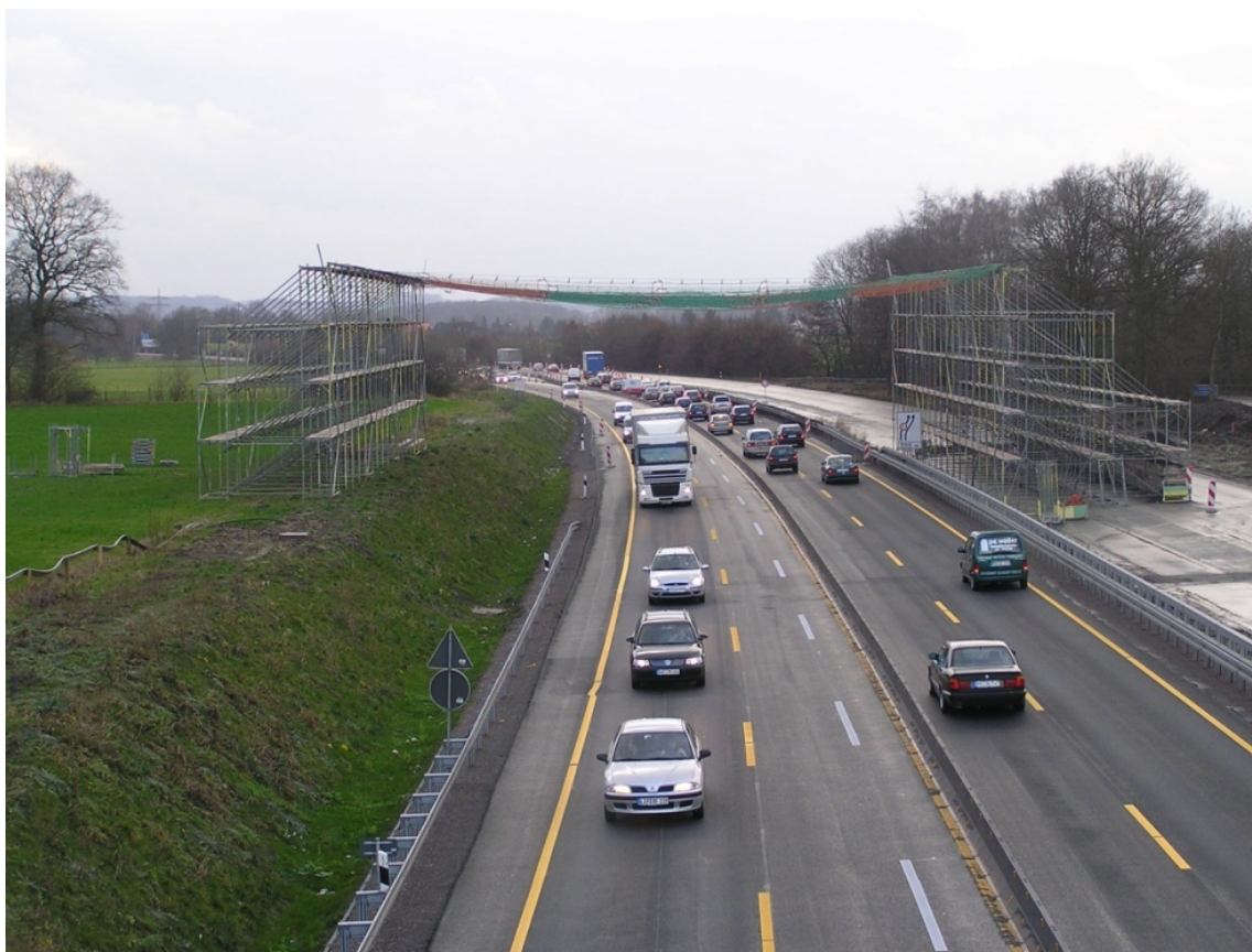
Abbildung 21: Stahlrohrschutzkonstruktion mit Netz über einer Autobahn
