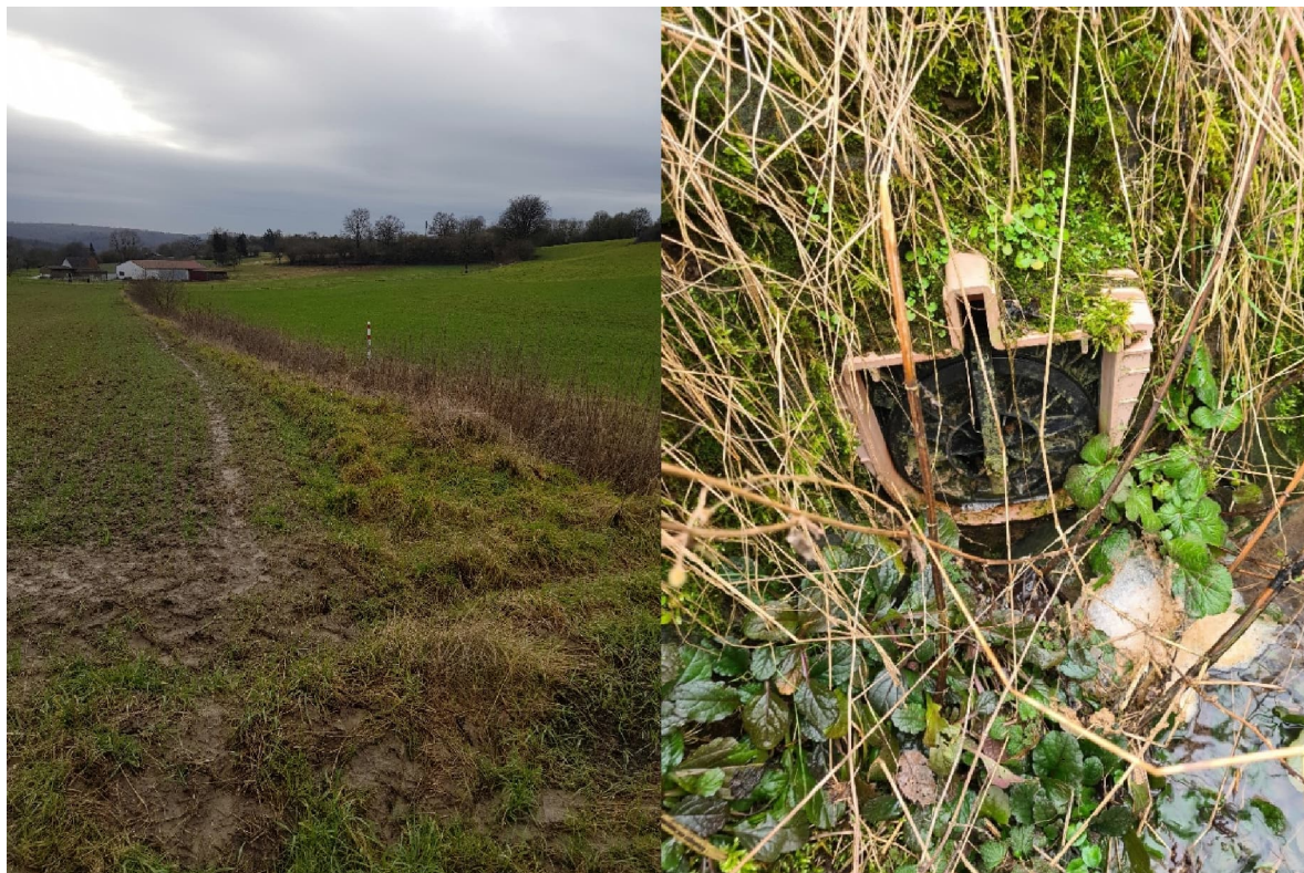
Abbildung 5: Bild links: Zulauf aus Westen am Michelbach ist mit einem rot-weißen Markierungspfosten gekennzeichnet. Abstromig liegt ein Gehöft; Bild rechts: Zulauf zum Michelbach aus Richtung Westen (Rohr mit Klappe)
