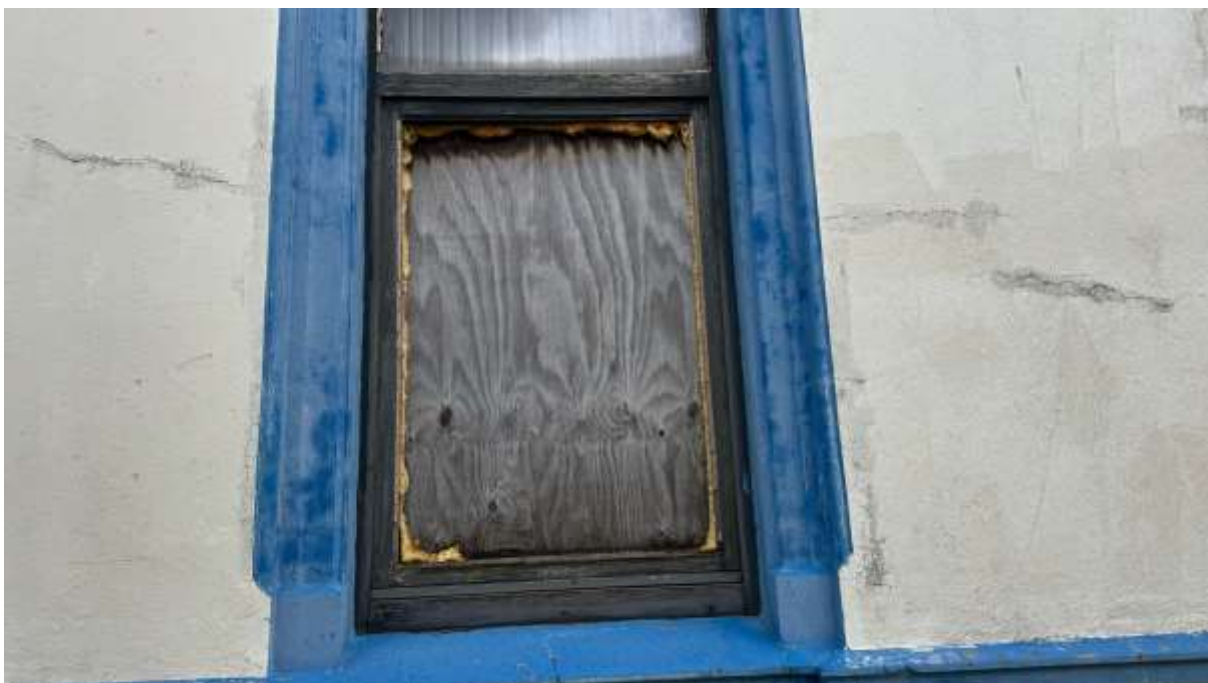
Abb. 3: Mit einer Holzplatte und Bauschaum abgedichtete Fensteröffnung des ehemaligen Hafenmeisterhauses, Aufnahme: 01.07.2024
