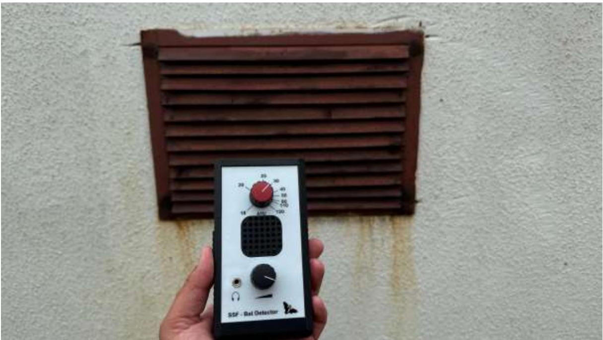
Abb. 11: Untersuchung der Lüftungsschlitze einer Trafostation mit dem Fledermaus-Detektor, Aufnahme: 01.07.2024
