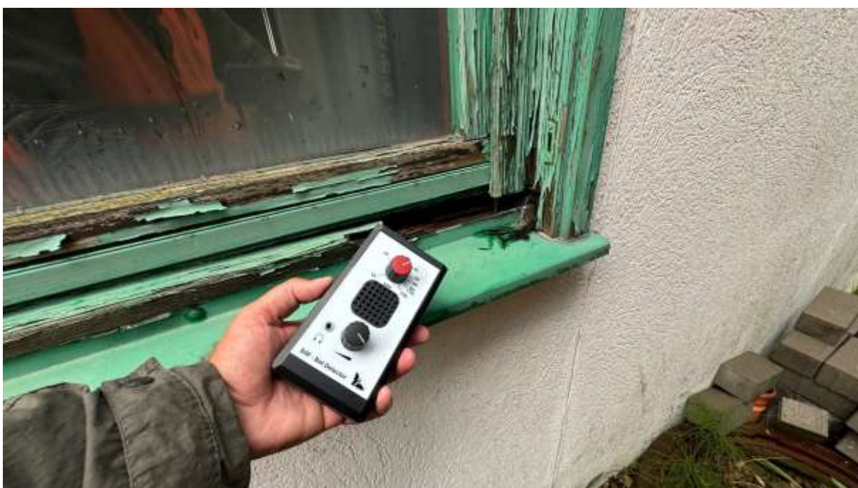
Abb. 4: Untersuchung eines morschen Fensterrahmens an den ehem. Gebäuden der Verwaltung mit dem Fledermaus-Detektor, Aufnahme: 01.07.2024
