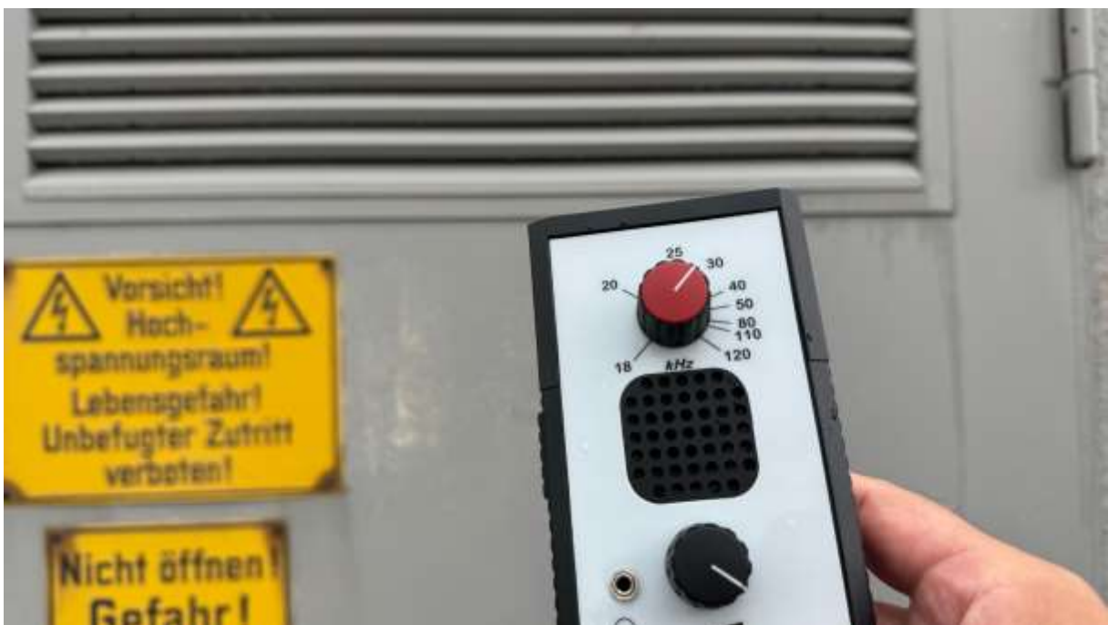
Abb. 10: Untersuchung einer Trafostation mit dem Fledermaus-Detektor, Aufnahme: 01.07.2024
