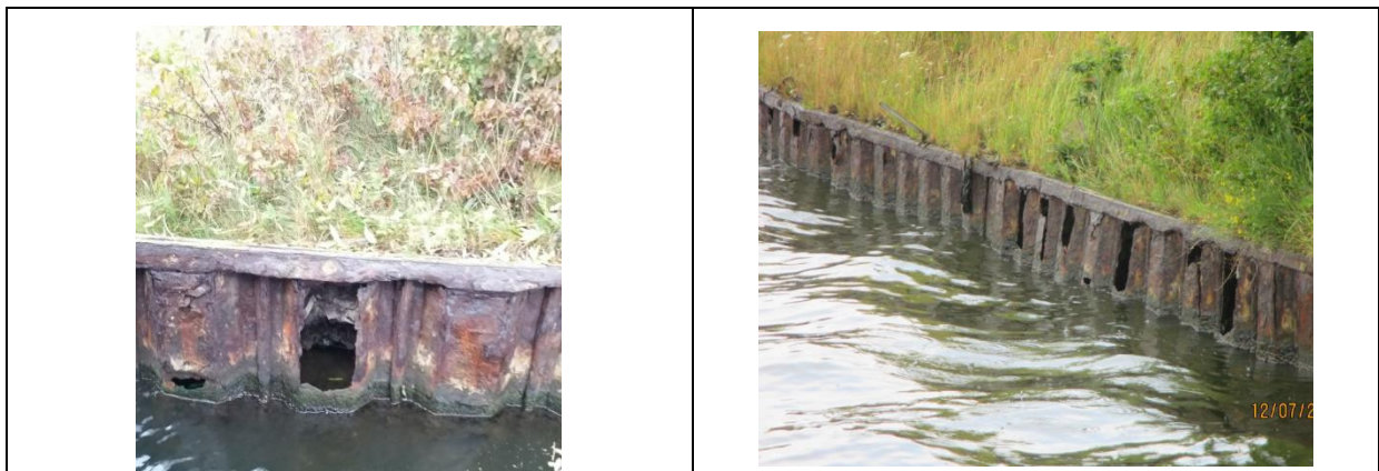
Abbildung 9: Zustand Spundwand Böschungsfuß
