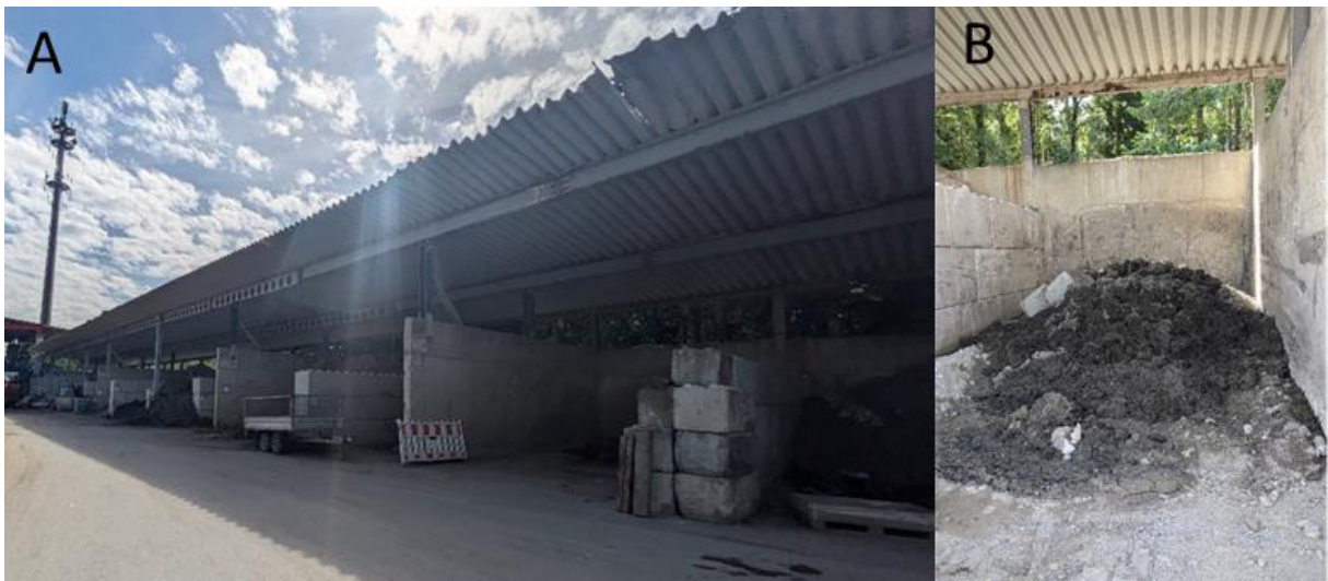
Abbildung 6, Betroffene Schüttboxen (4 Stück, jeweils mit Zwischenmauer unterteilt) (A), aktueller Stand der Bauweise der Schüttboxen, inkl. erdfeuchter Abfälle (B)
