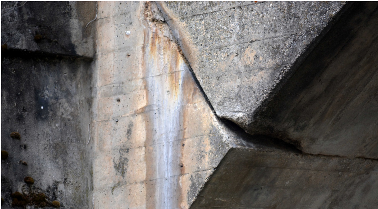
Abb. 12: Eisenbahnbrücke: Auf geweiteter Spalt im Mauerwerk durch Abbruchstelle im Gewölbebogen.
