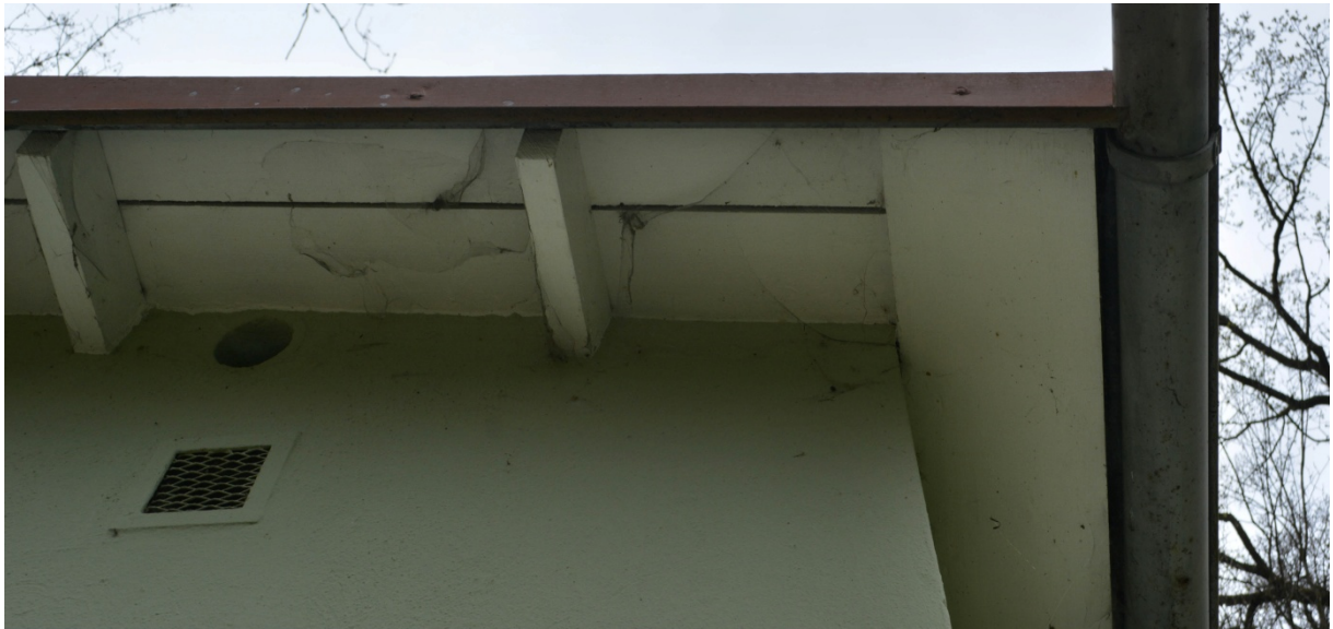
Abb. 6: Außenfassade von Gebäude 1 mit Einflugloch, Spalt zwischen Holzbrettern und Spalt neben Regenrinne.
