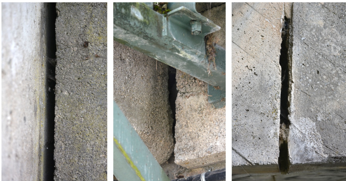
Abb. 10: Eisenbahnbrücke: Typische vertikale Spalten im Mauerwerk der Brücke (links & mitte: Ecklage, rechts: Bruchstelle in einem Gewölbebogen), teilweise mit Spinnweben verhängen. Tagesversteck möglich.
