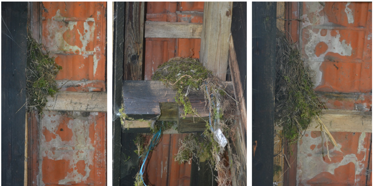
Abb. 7: Drei Vogelnester am Gebälk des Dachstuhls (Außenfassade) der Holzhütte.
