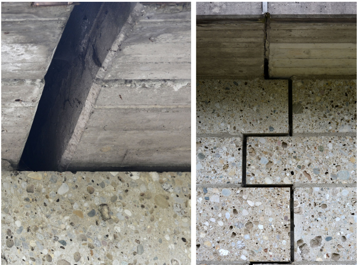
Abb. 13: B299 Brücke: Schmäler horizontaler Spalt im Tragwerk mündet in größeren Hohlraum (links). Rechts: Fehlender Fugenputz ermöglicht Zugang zu tieferen Spalten, insbesondere im bodenfernen, oberen Bereich.
