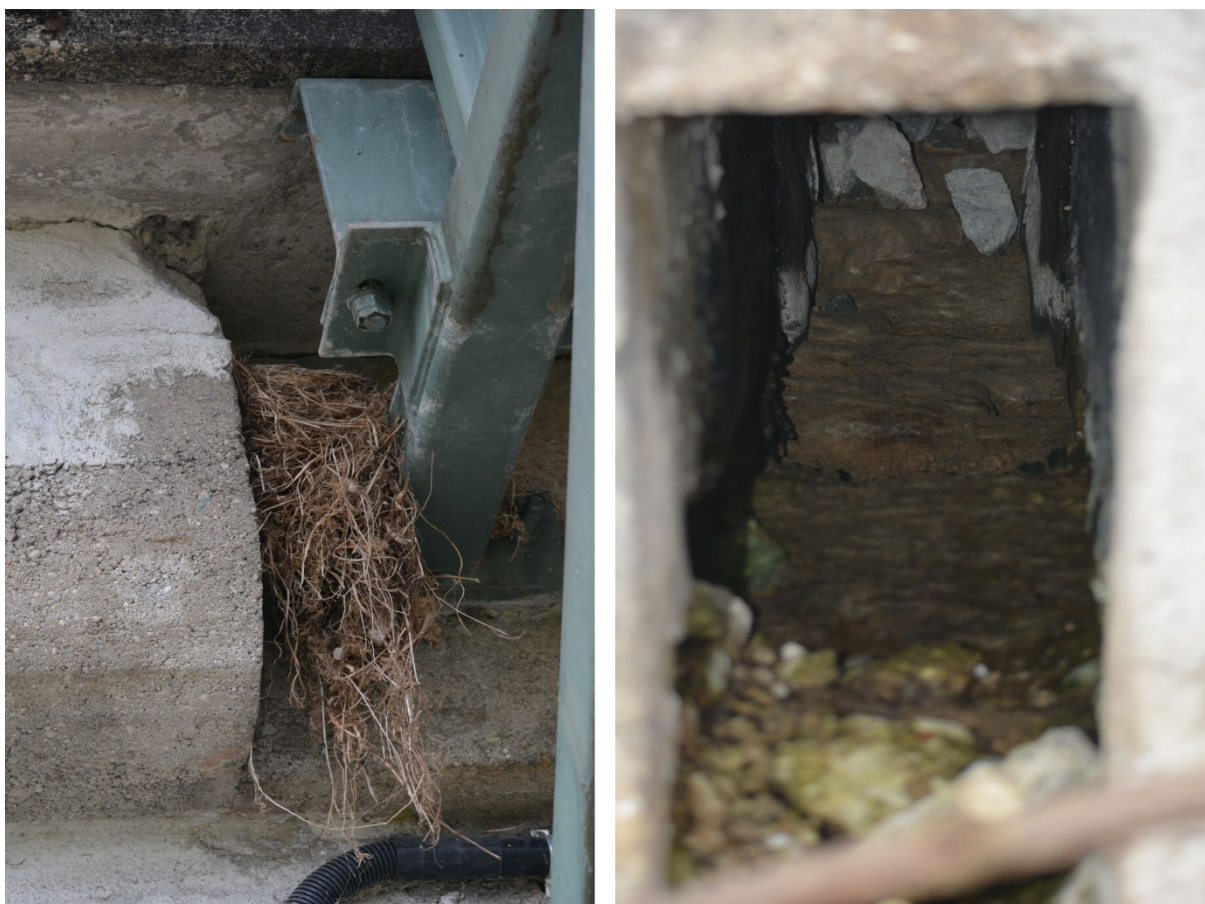
Abb. 11: Eisenbahnbrücke: Vogelnest auf Stahlträger für Gelände (links), ausgeleuchteter Regenabflussschacht mit Geröll und getrocknetem Schlamm (rechts).
