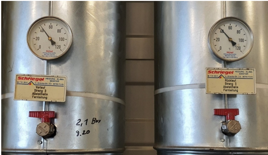
Abbildung 34: Bestehende Heizungsversorgung der Abstellhalle an Achse C Reihe 4
