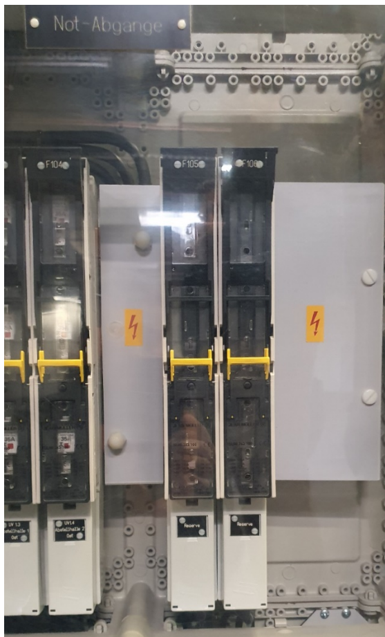
Abbildung 39: NSHV 4 - NOT-Teil, freie Reserveabgänge F105, F106 und verfügbarer Einbauplatz
