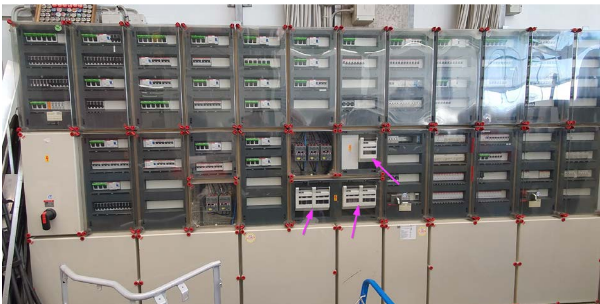
Abbildung 42: UV Last 2 mit markierten freien Reserveabgängen
