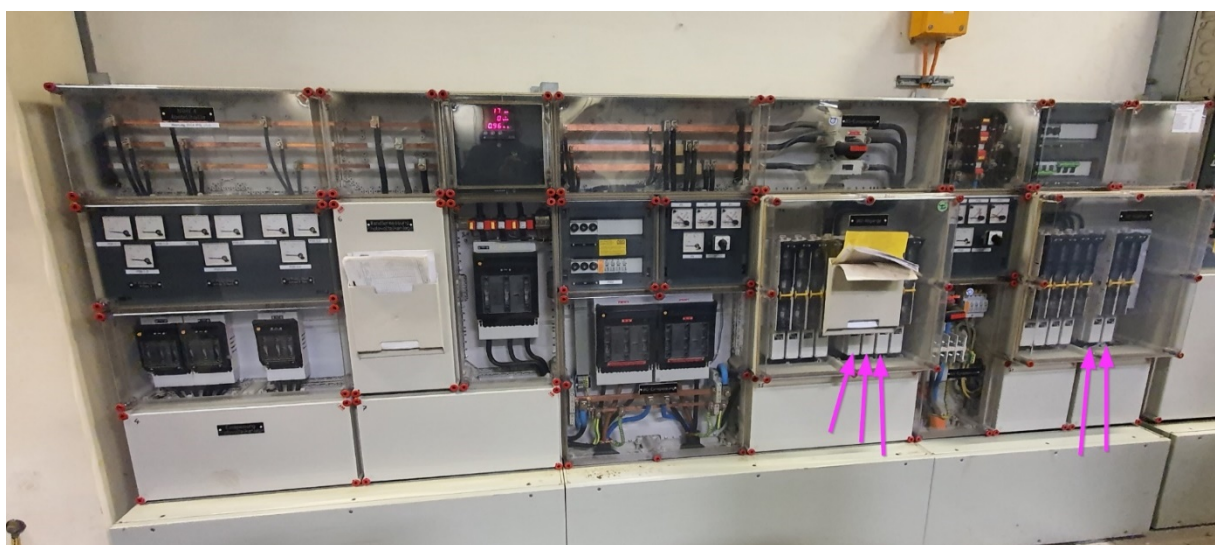
Abbildung 37: NSHV 4 mit freien Abgängen (3x VAG, 2x NOT)
