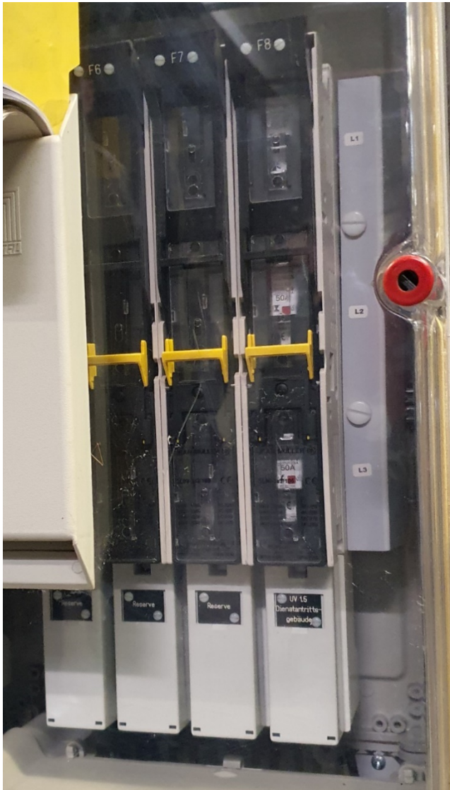
Abbildung 38: NSHV 4 – VAG-Teil, Freie Reserveabgänge F5 bis F7
