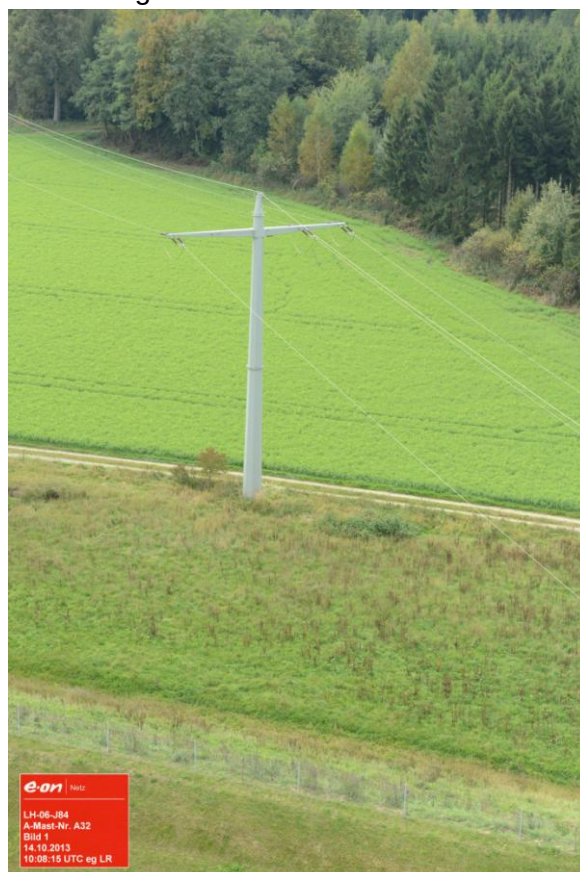
Foto 4: Ltg- Nr. J84 – Mast Nr. A32
