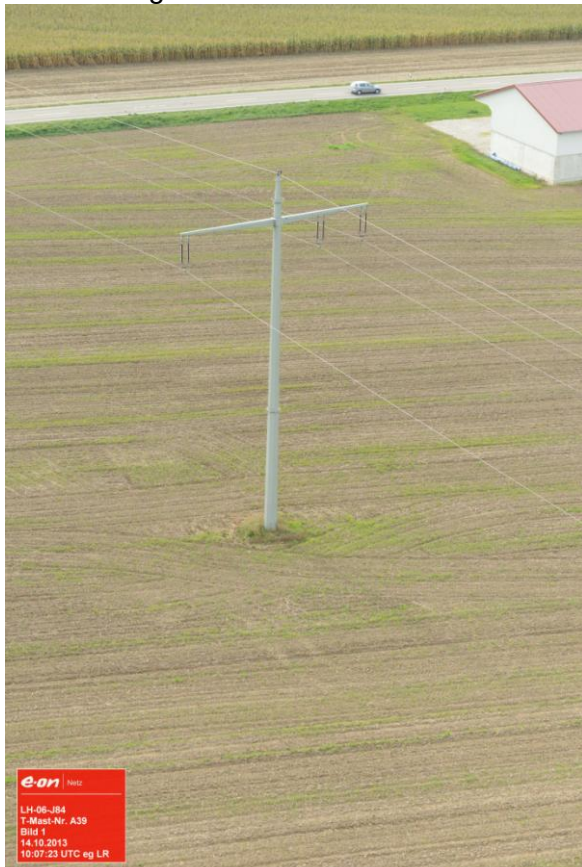
Foto 11: Ltg- Nr. J84 – Mast Nr. A39
