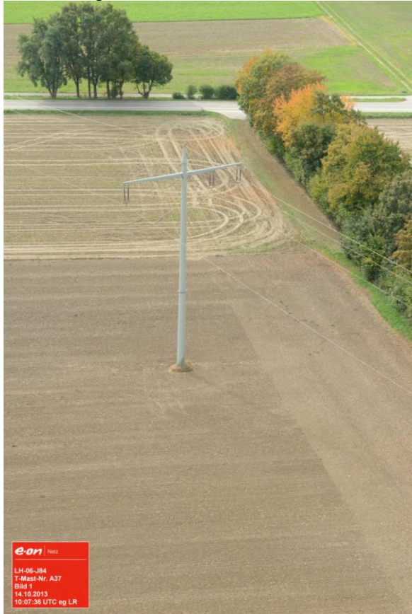
Foto 9: Ltg- Nr. J84 – Mast Nr. A37
