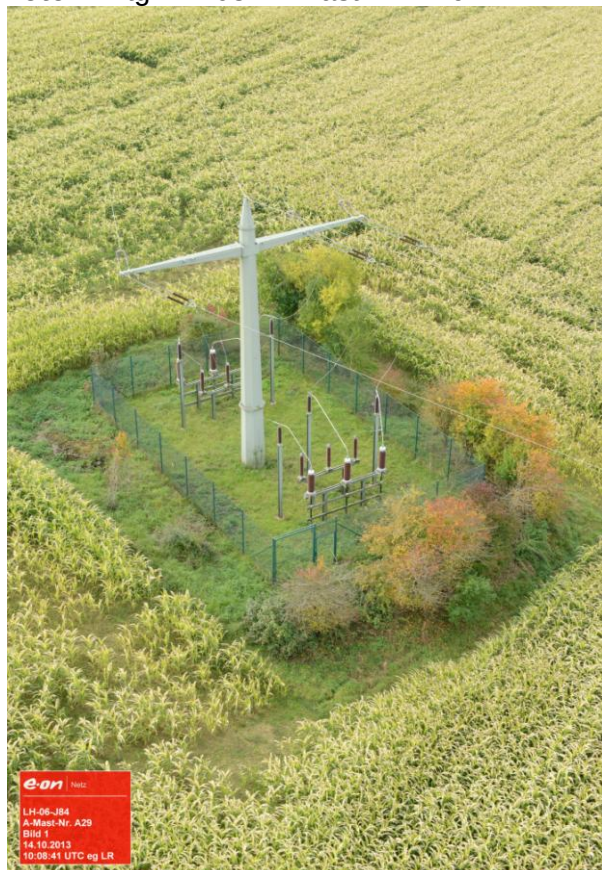
Foto 1: Ltg- Nr. J84 – Mast Nr. A29
