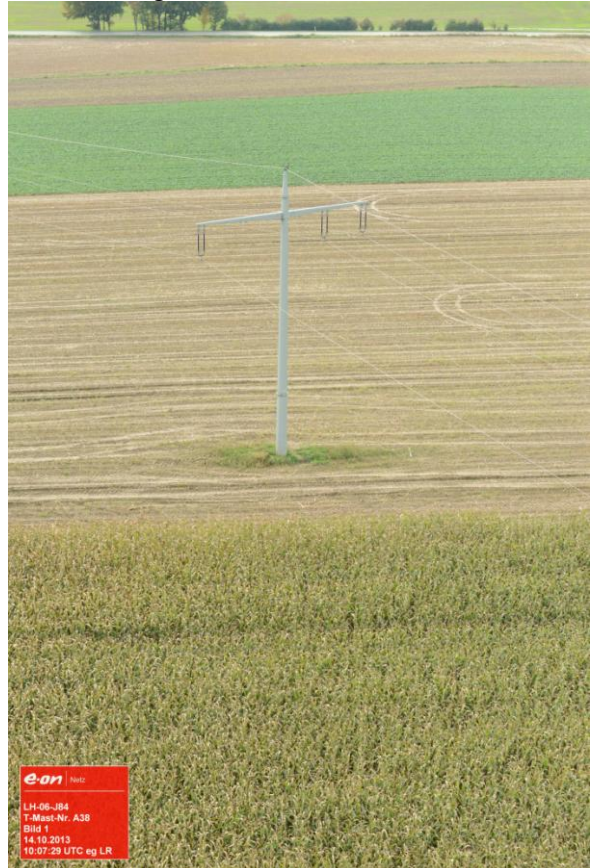
Foto 10: Ltg- Nr. J84 – Mast Nr. A38
