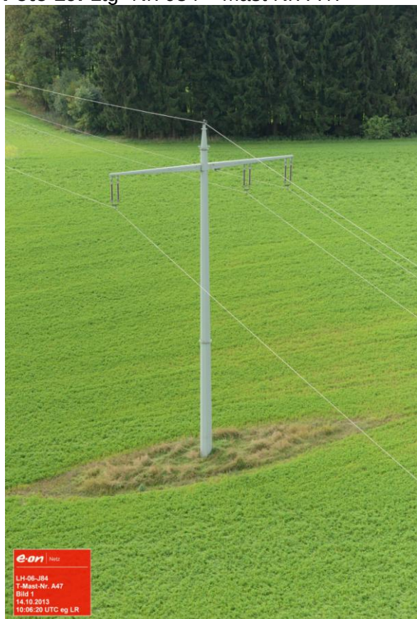
Foto 19: Ltg- Nr. J84 – Mast Nr. A47
