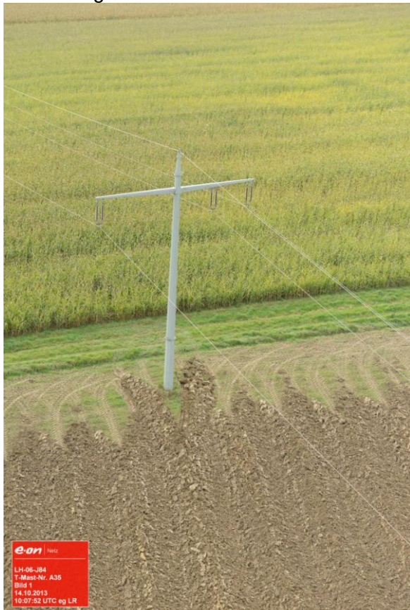
Foto 7: Ltg- Nr. J84 – Mast Nr. A35
