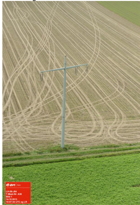
Foto 8: Ltg- Nr. J84 – Mast Nr. A36
