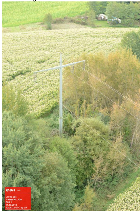
Foto 2: Ltg- Nr. J84 – Mast Nr. A30
