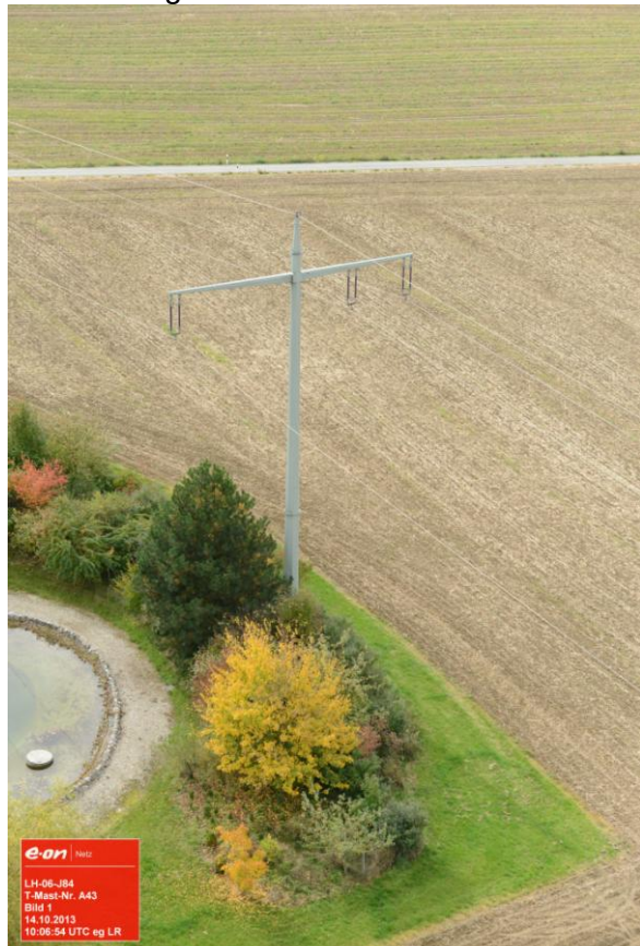
Foto 15: Ltg- Nr. J84 – Mast Nr. A43
