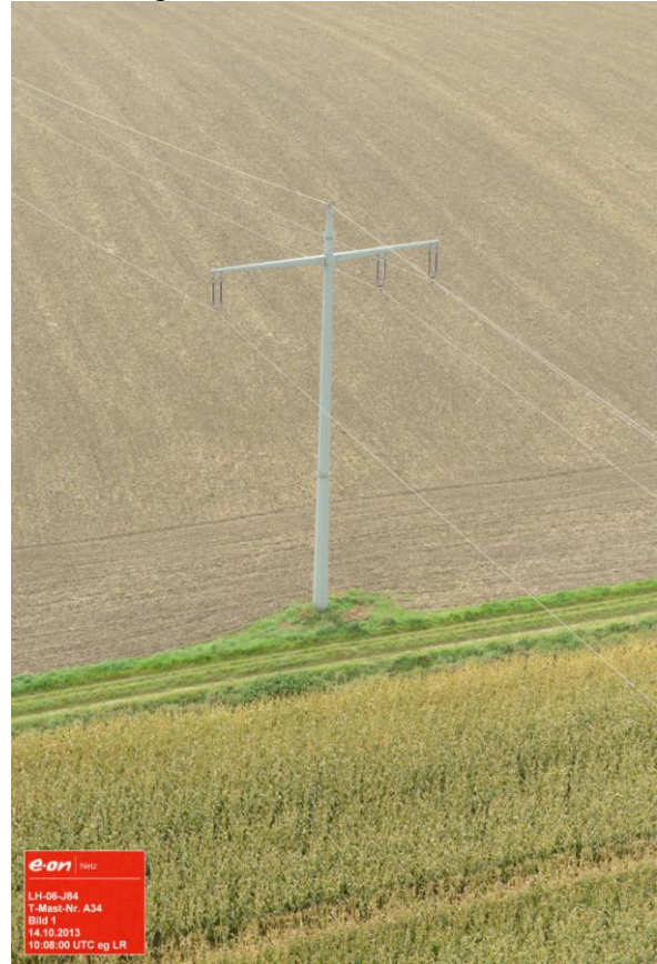
Foto 6: Ltg- Nr. J84 – Mast Nr. A34
