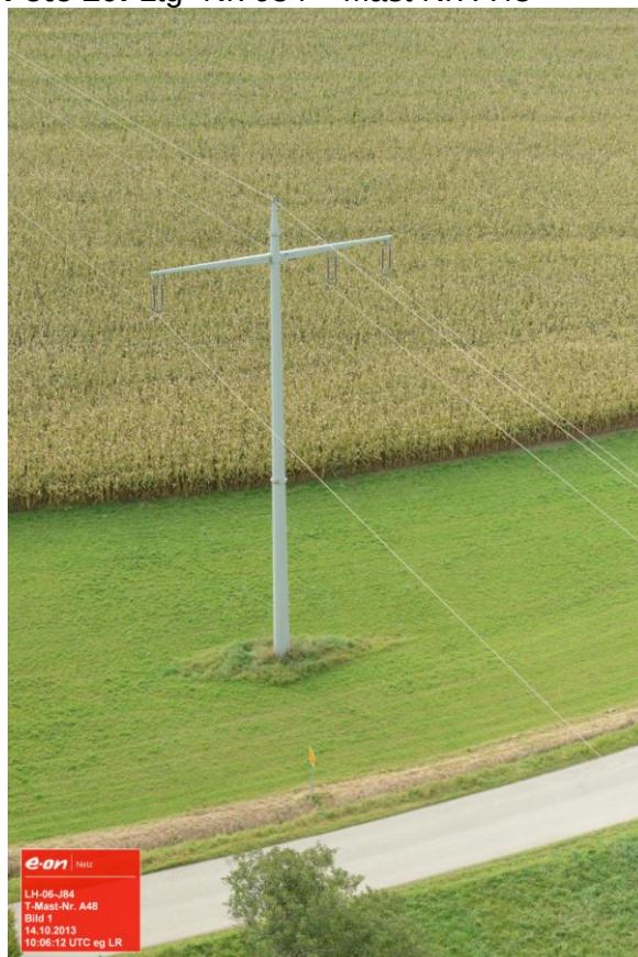
Foto 20: Ltg- Nr. J84 – Mast Nr. A48
