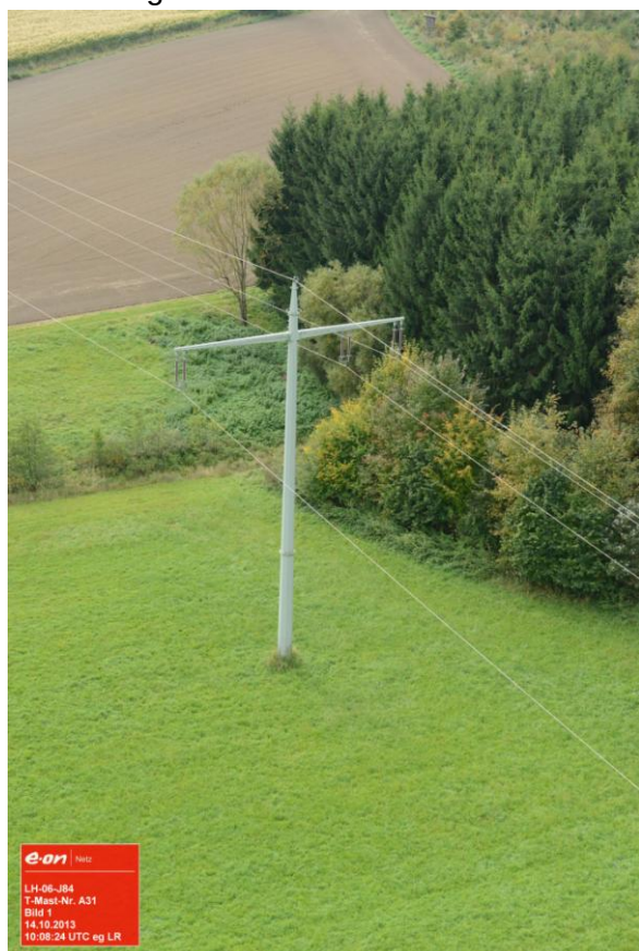
Foto 3: Ltg- Nr. J84 – Mast Nr. A31
