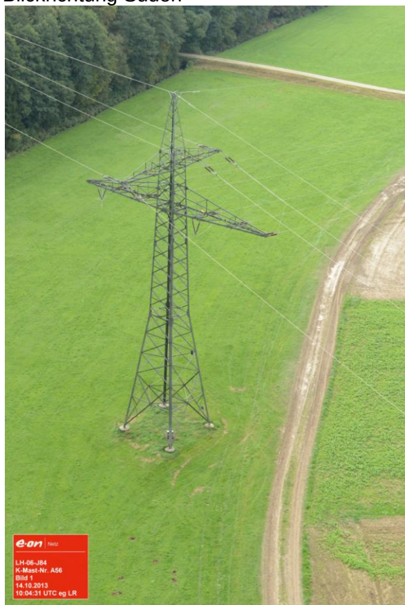
Foto 28: Ltg- Nr. J84 – Mast Nr. A56, Blickrichtung Süden
