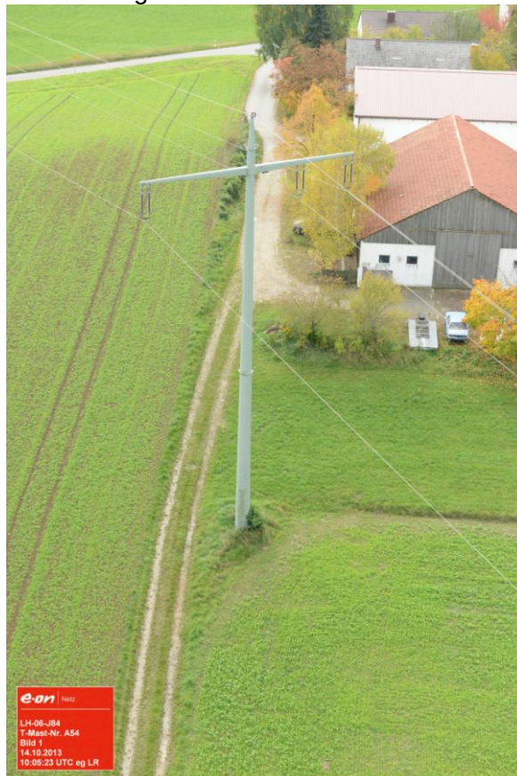
Foto 26: Ltg- Nr. J84 – Mast Nr. A54
