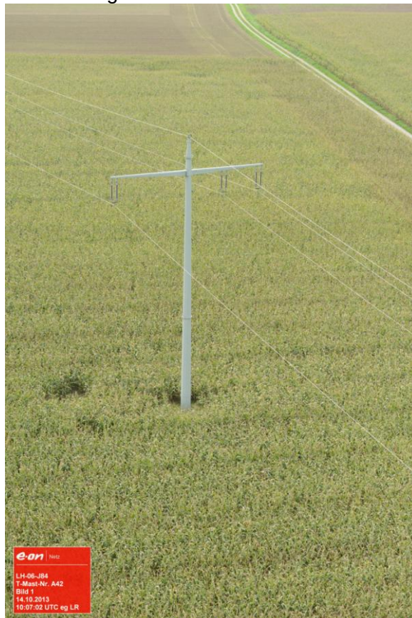
Foto 14: Ltg- Nr. J84 – Mast Nr. A42
