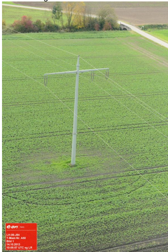
Foto 22: Ltg- Nr. J84 – Mast Nr. A50
