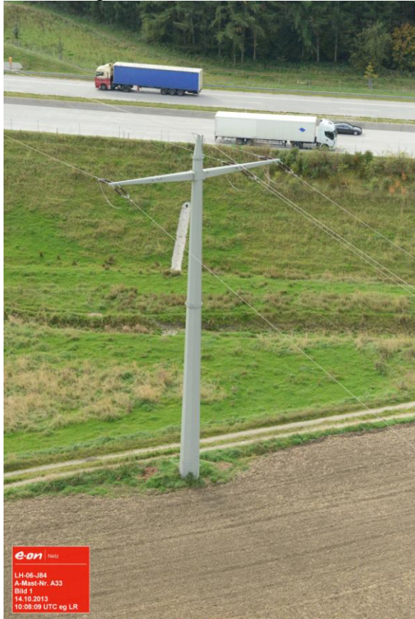
Foto 5: Ltg- Nr. J84 – Mast Nr. A33
