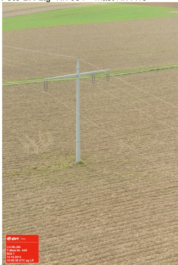
Foto 17: Ltg- Nr. J84 – Mast Nr. A45
