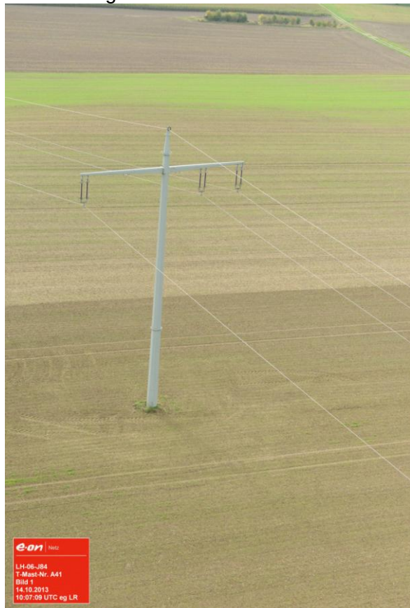
Foto 13: Ltg- Nr. J84 – Mast Nr. A41
