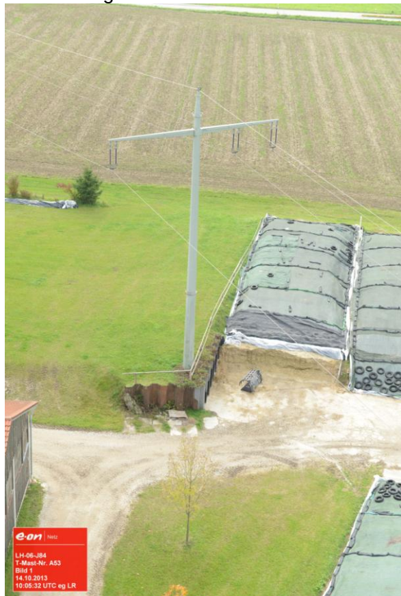
Foto 25: Ltg- Nr. J84 – Mast Nr. A53
