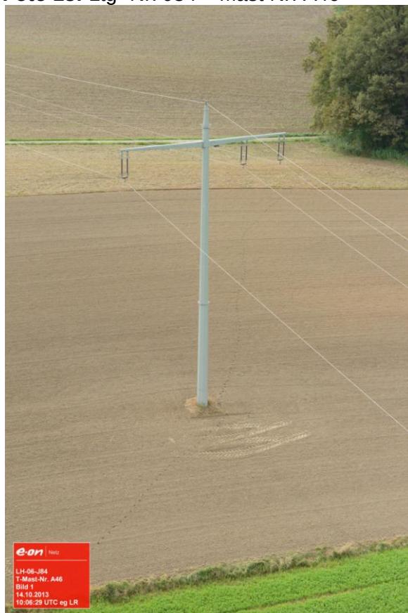
Foto 18: Ltg- Nr. J84 – Mast Nr. A46
