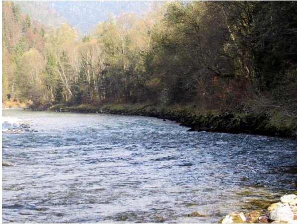
Abb. 10.10: Vom Aschauerbach flussabwärts ist das orographisch rechte Ufer auf ca. 350 m Länge mit Blockwurf verbaut.
