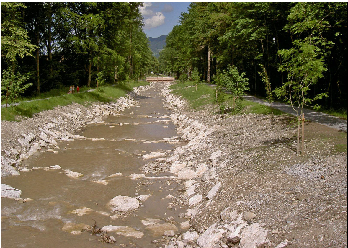
Abb. 18 Wildbachverbauung, Ufersicherung und staffelartig angeordnete Sohlgurte, Brannenburg in Oberbayern. Fotos: Flatscher, 20.06.2004
