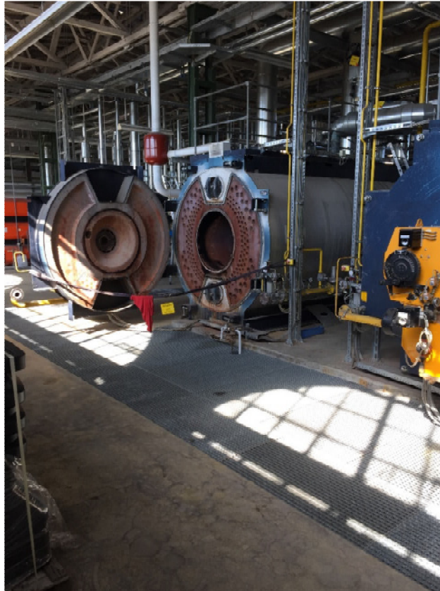
Abb. 15: Kesselhaus, Anlage Nr. 6, Innenansicht mit Heizkesseln
