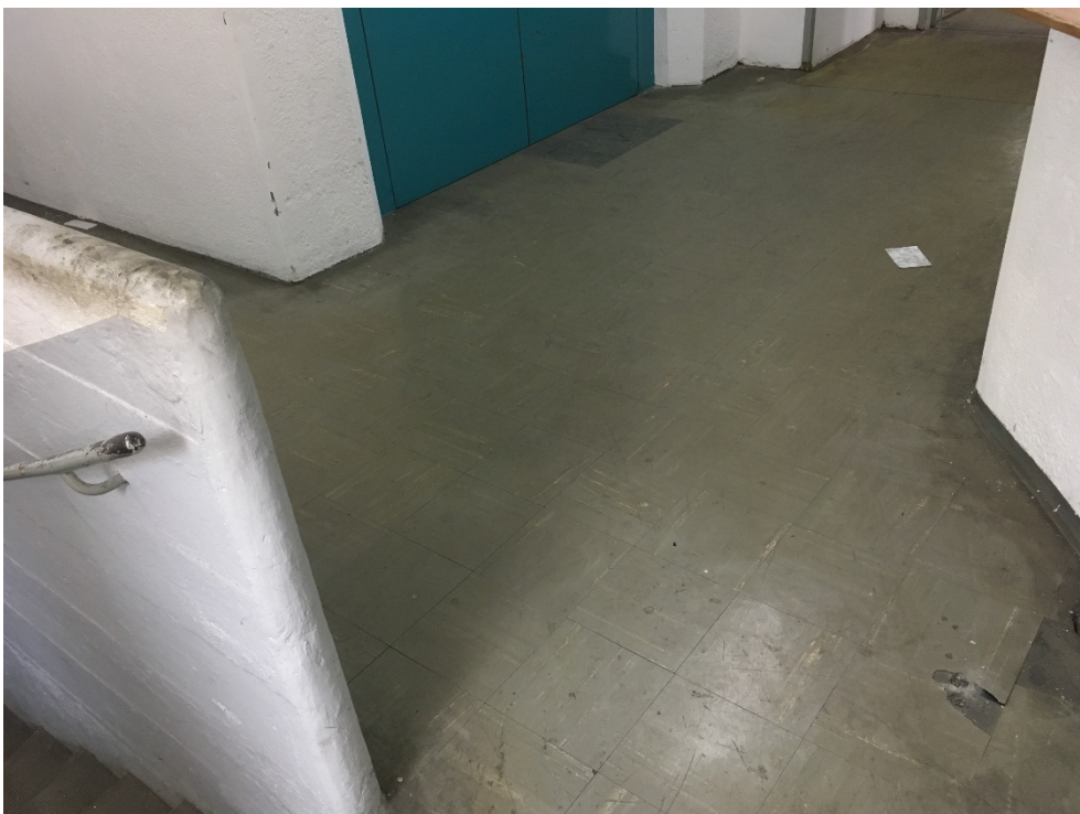
Abb. 12: Hauptwerkstätten (Montagehalle), Anlage Nr. M/4, Verwaltungstrakt mit asbesthaltigen Floor-Flex-Platten und asbesthaltigen schwarzen Bitumenkleber
