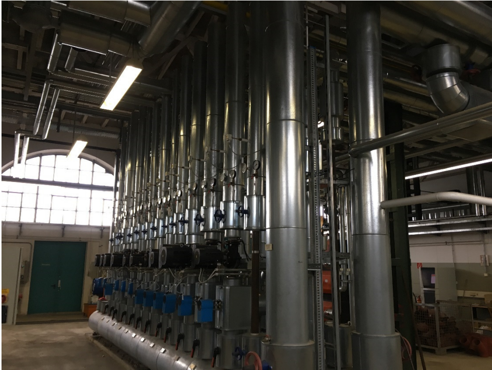
Abb. 17: Kesselhaus, Anlage Nr. 6, Heiztechnik
