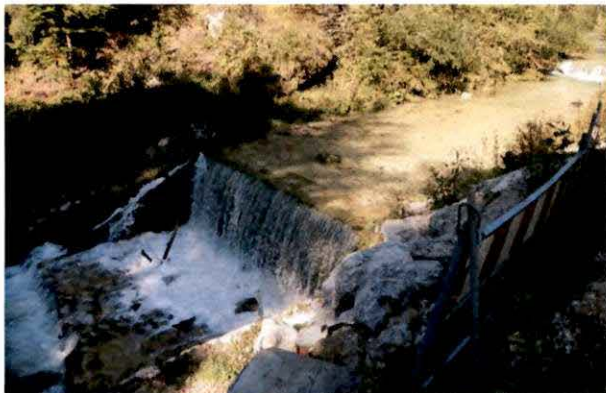
Abbildung 10: Bischofswiesener Ache Querbauwerk Nr. 5 und Nr. 6
