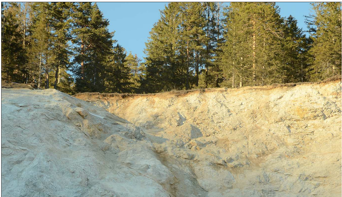
Abbildung 1: Felsböschung im Ramsaudolomit mit geringmächtiger Hangschuttauflage
