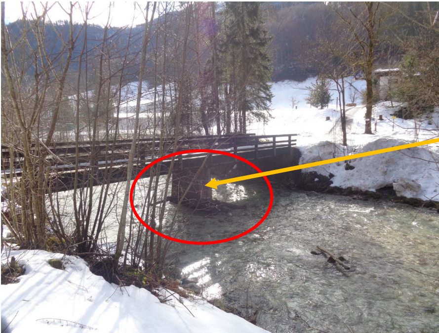
Brückenpfeiler, wenig Freibord bei Hochwasser
