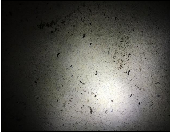
Abb. 14: Kot (relativ groß) in den Widerlagern und Hohlkästen. Aufgefunden während der Winterbegehung.
