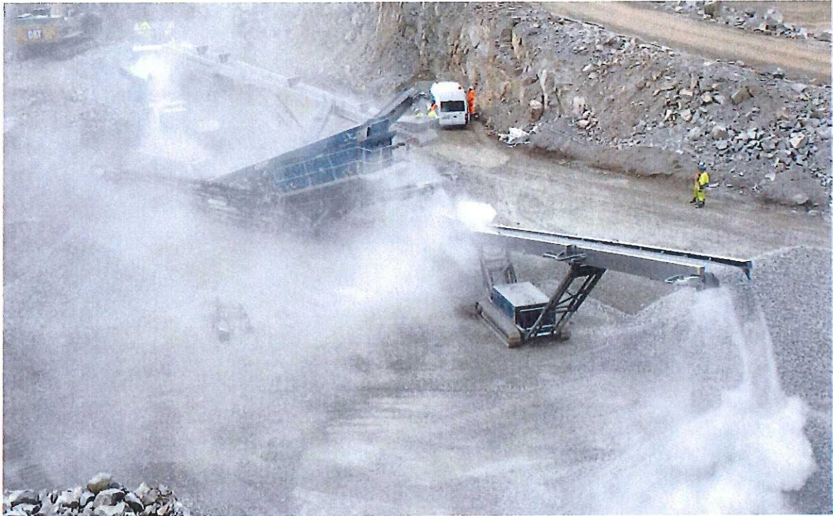
Abbildung 2: Betrieb des Anlagenzuges ohne Niederdrucksprühsystem
