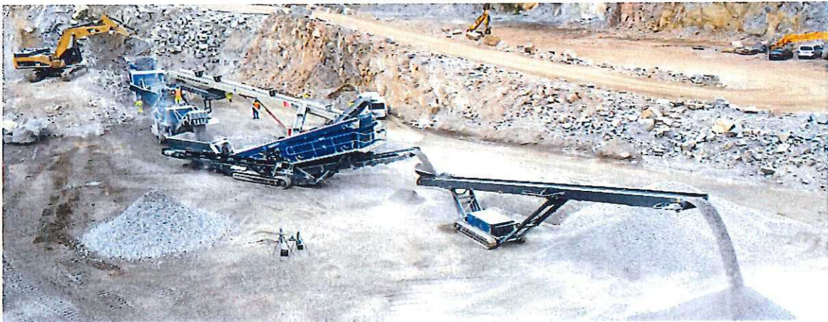
Abbildung 1: Gesamter Anlagenzug der Firma Kleemann
