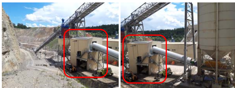
Abb. 3 + 4 – Umlenkgebäude mit Sekundärbrecher ‚Hazemag HSI 1625‘
