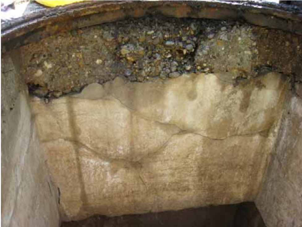
Abbildung 4: Starke Erosion im oberen Schachtteil
