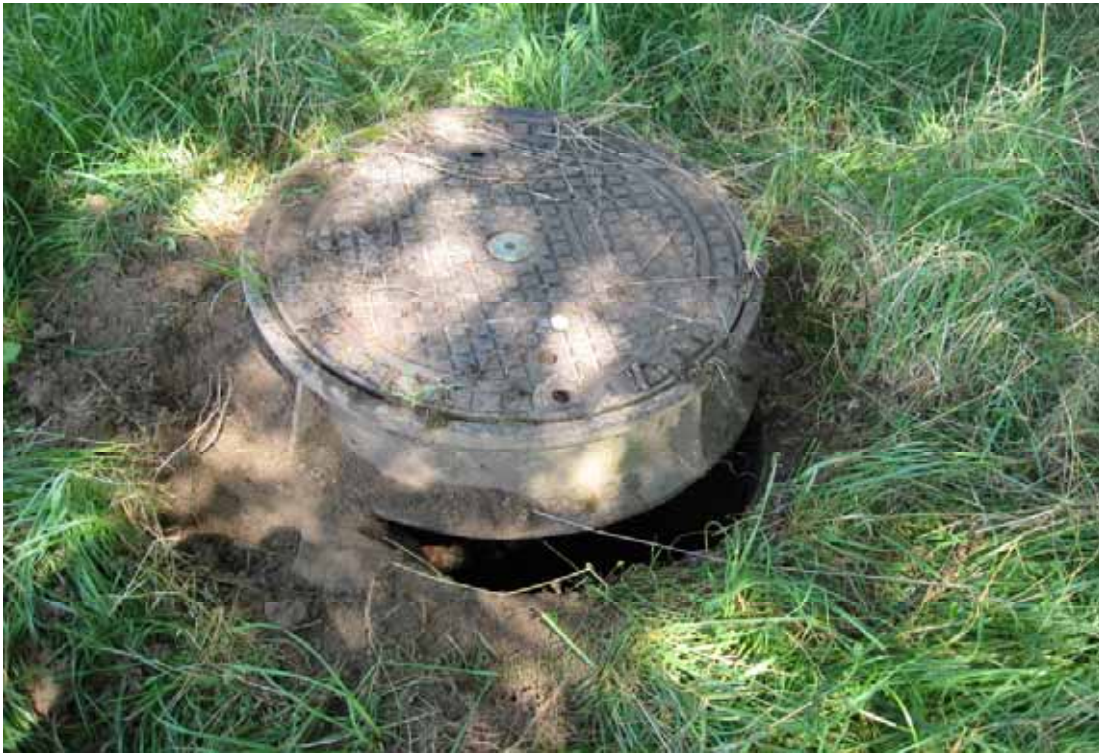
Abbildung 10: Schacht 6b mit aus der Verankerung gerissenem Abschlussdeckel
