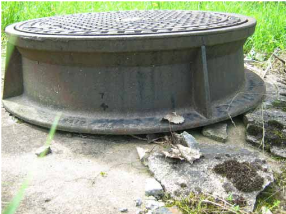
Abbildung 9: Schachtsockel des Sammelschachts 6a.
