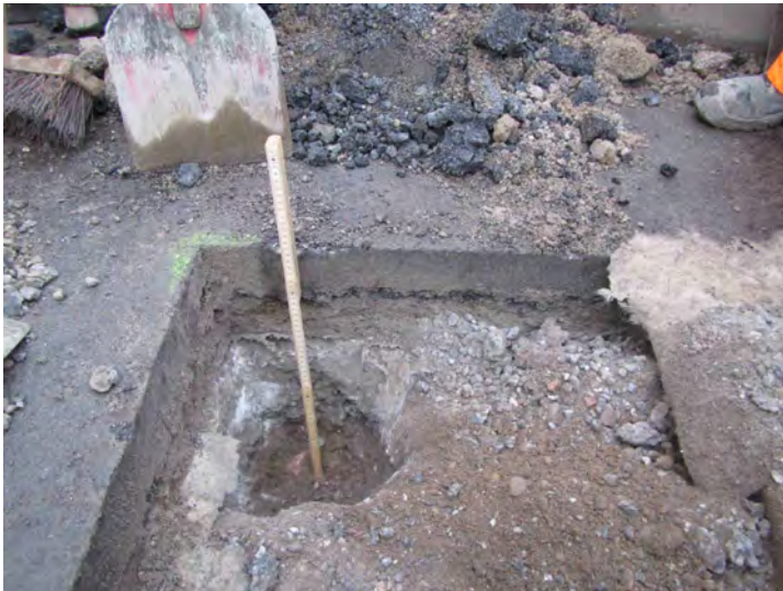
Oberbauschichten im Bereich der Linde, die Gesamtdicke des Aufbaus beträgt ca. 50 cm
