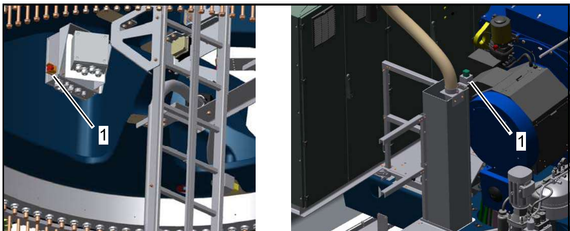
Abb. 24: Ausschalter Mittelspannung (1) an Box 8 und am Kettenkasten des Elektrokettenszugs
