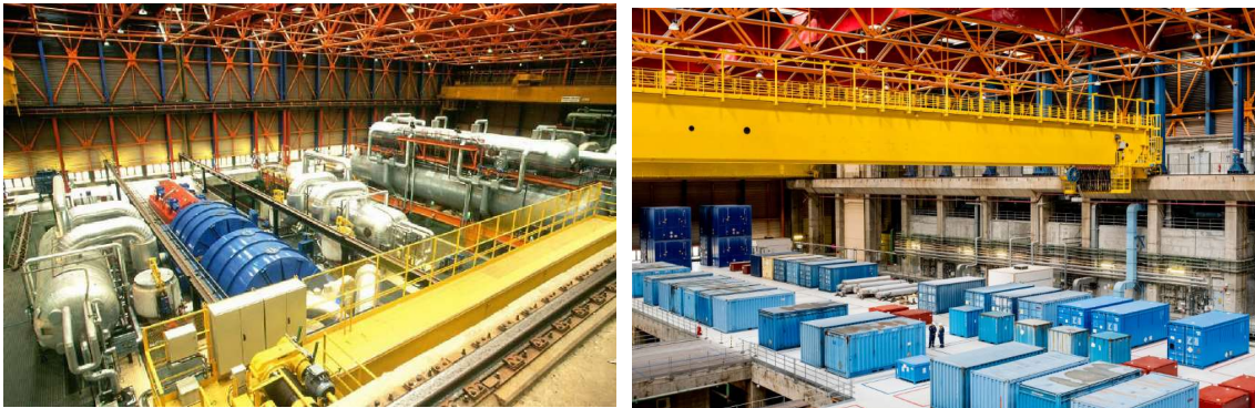
Figure 2.k Illustration de la reconfiguration de la salle des machines en Installation de Découplage et de Transit – Exemple du site de Creys-Malville © EDF
