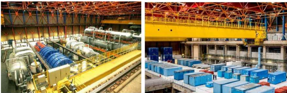
Abbildung 2.k Abbildung der Neukonfiguration des Maschinenraums in Entkopplungs- und Transitinstallation – Beispiel des Standorts Creys-Malville © EDF
