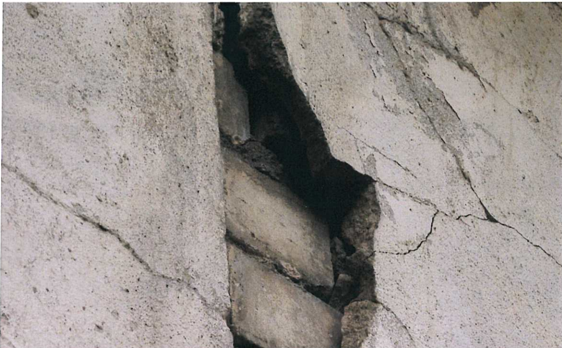
Abb. 4 Abgeplatzter Putz als potentielles Sommerquartier/Tagesversteck
