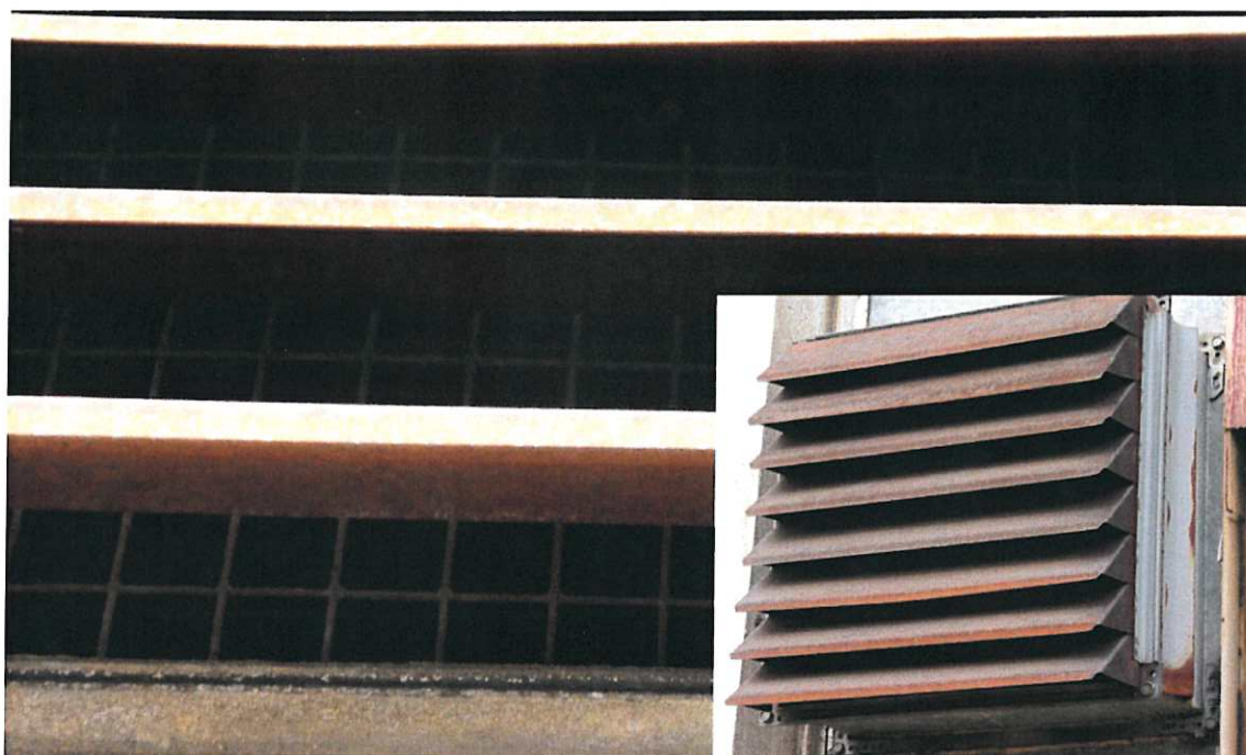
Abb. 3: Belüftungsöffnung mit Gitter
