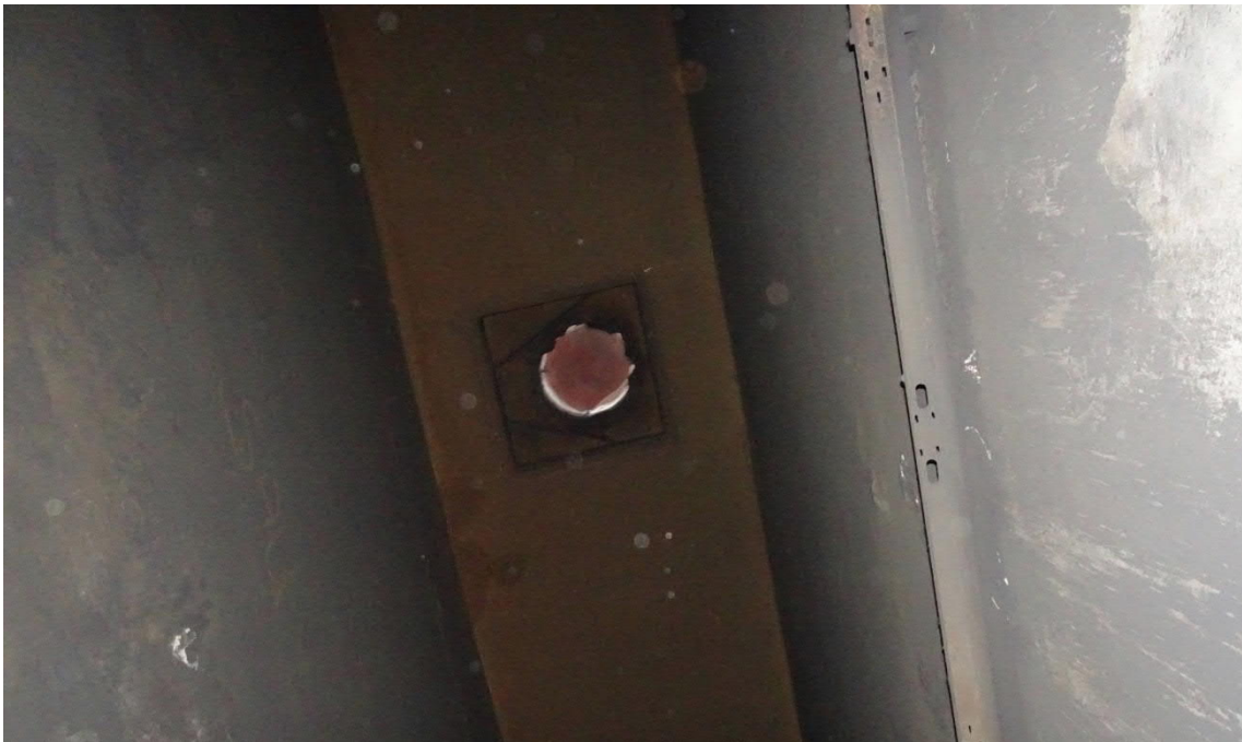
Abb. 5 Verschlussene und mit Netz verhangene Dachöffnung
