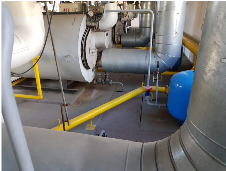
Detail DE008 Kesselraum
