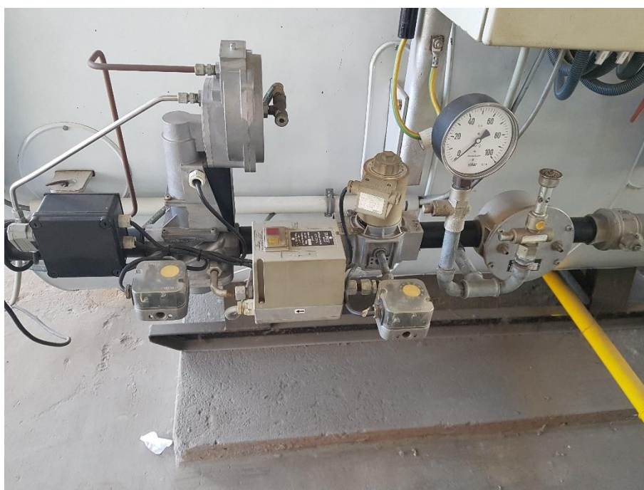
Detail DE008 Kesselraum
