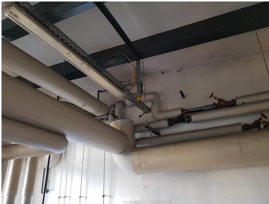
Detail DE009 Pumpenraum
