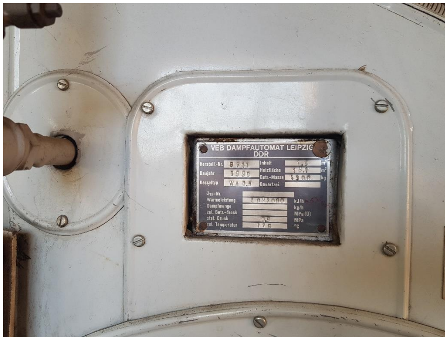
Detail Kessel DE008 Kesselraum
