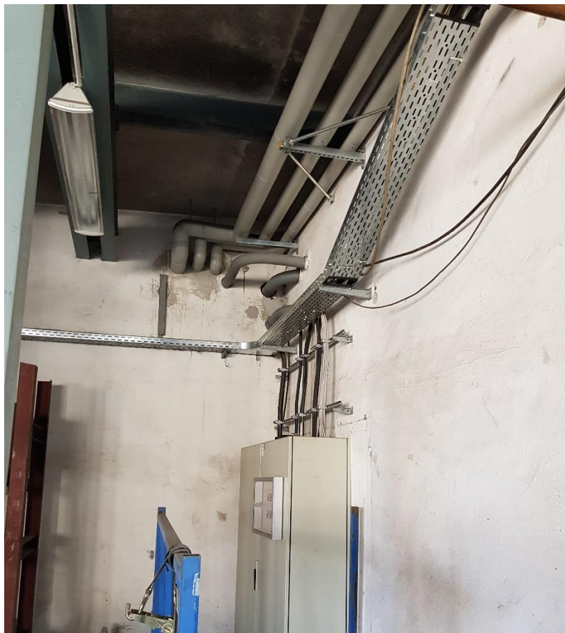
Detail Kabelbrücken und Leuchtstofflampen DE011 Materiallager sowie in sämtlichen Räumen
