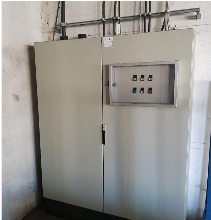
Elektrohauptverteiler DE011 Materiallager
