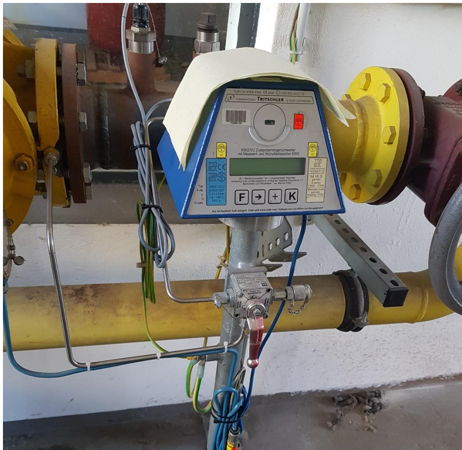
Detail DE008 Kesselraum
