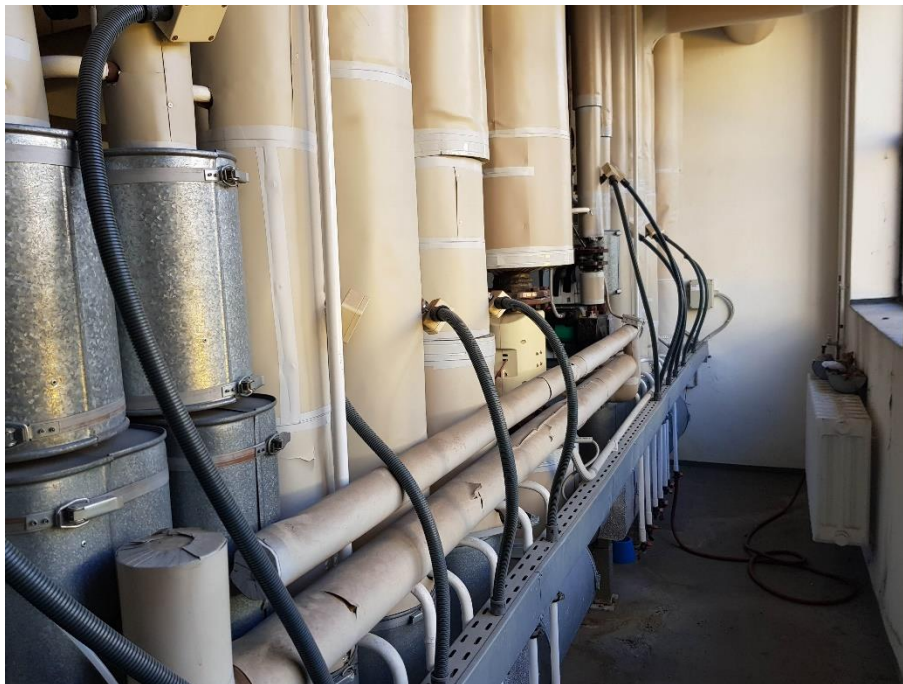
Detail DE009 Pumpenraum
