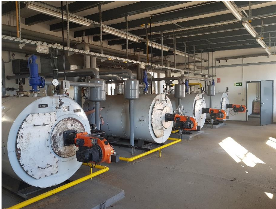
Übersicht Kesselraum DE008 Kesselraum
