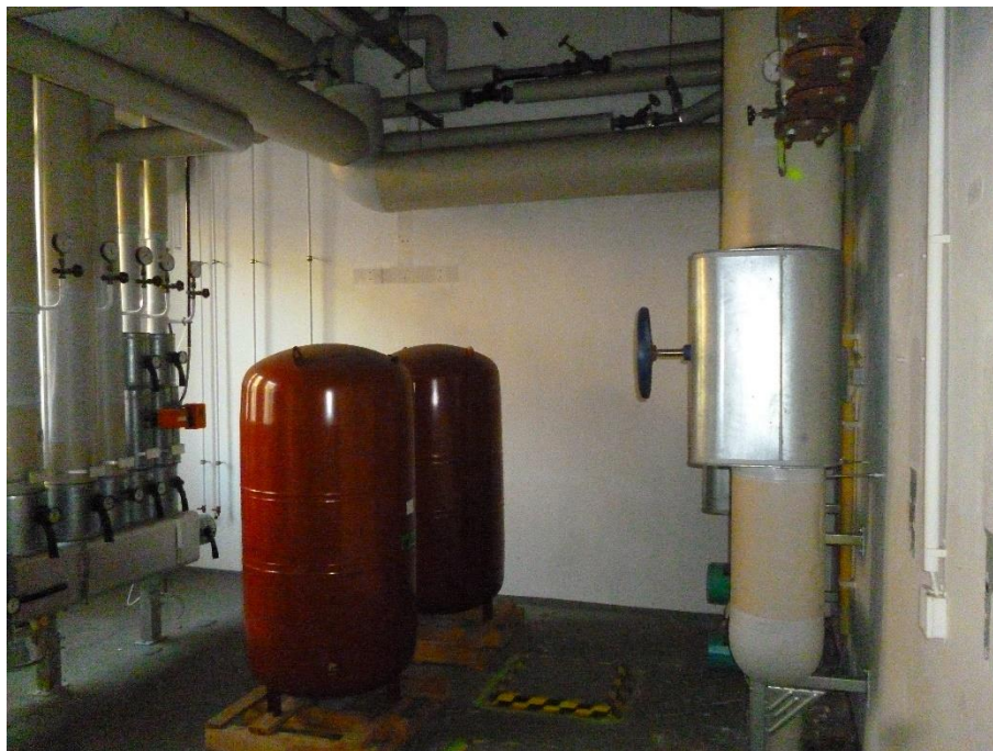
weiter DE009 Pumpenraum
