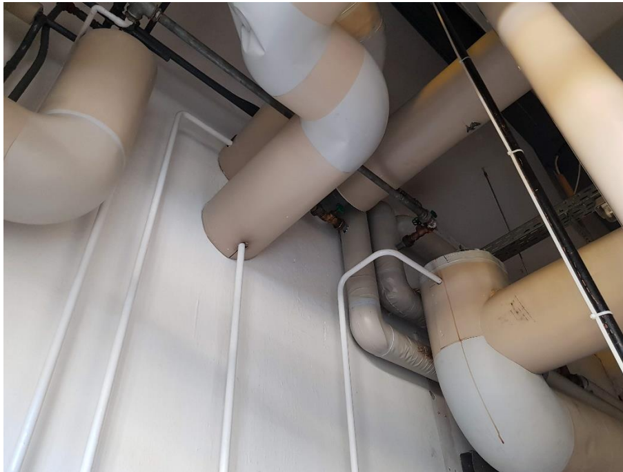
Detail DE009 Pumpenraum
