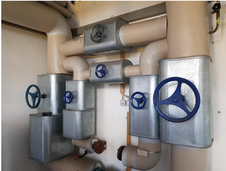
Detail DE009 Pumpenraum
