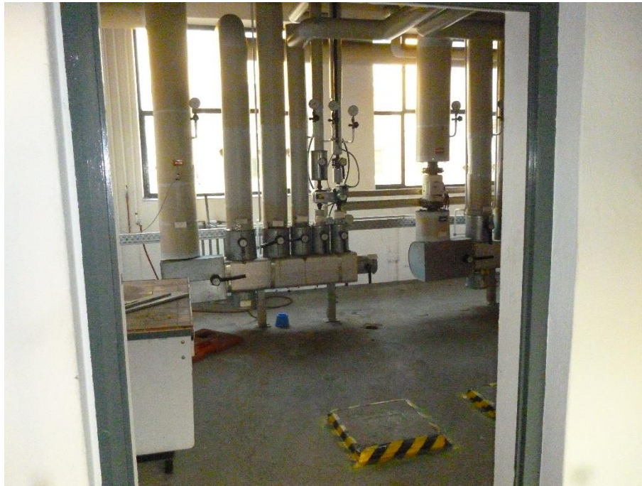
Übersicht Raum DE009 Pumpenraum
