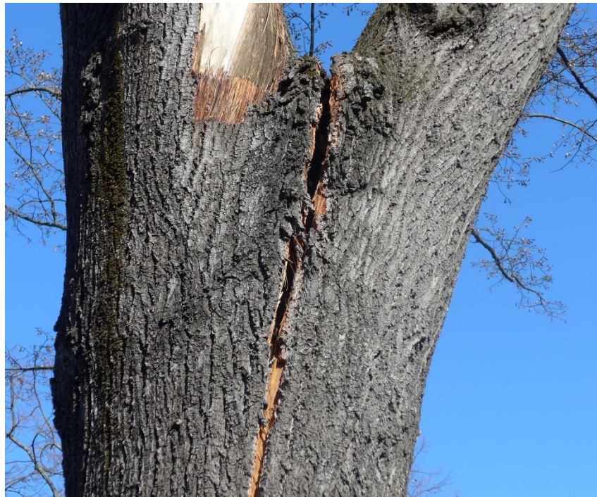
Abbildung 7: Spalt im Baum Nr. 9 in der Holteistraße
