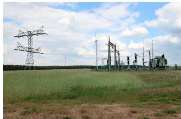
Abb. 73: Umspannwerk im Süden des UG, Fotostandort 40 nach ONO
