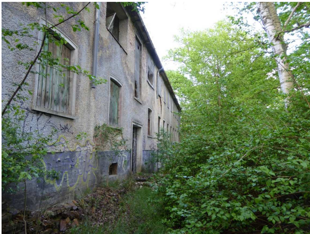
Abbildung 5: Blick auf die Südfassade. Die Fensteröffnungen sollen vermauert werden, wobei Fledermausquartiere (ggf. auch Vogel-Nischenbrütersteine) integriert werden. Die Dachentwässerung ist instand zu setzen und bedrängende jüngere Gehölze sind planvoll zu entfernen, auch um eine bessere Besonnung der Südfassade zu erreichen.
