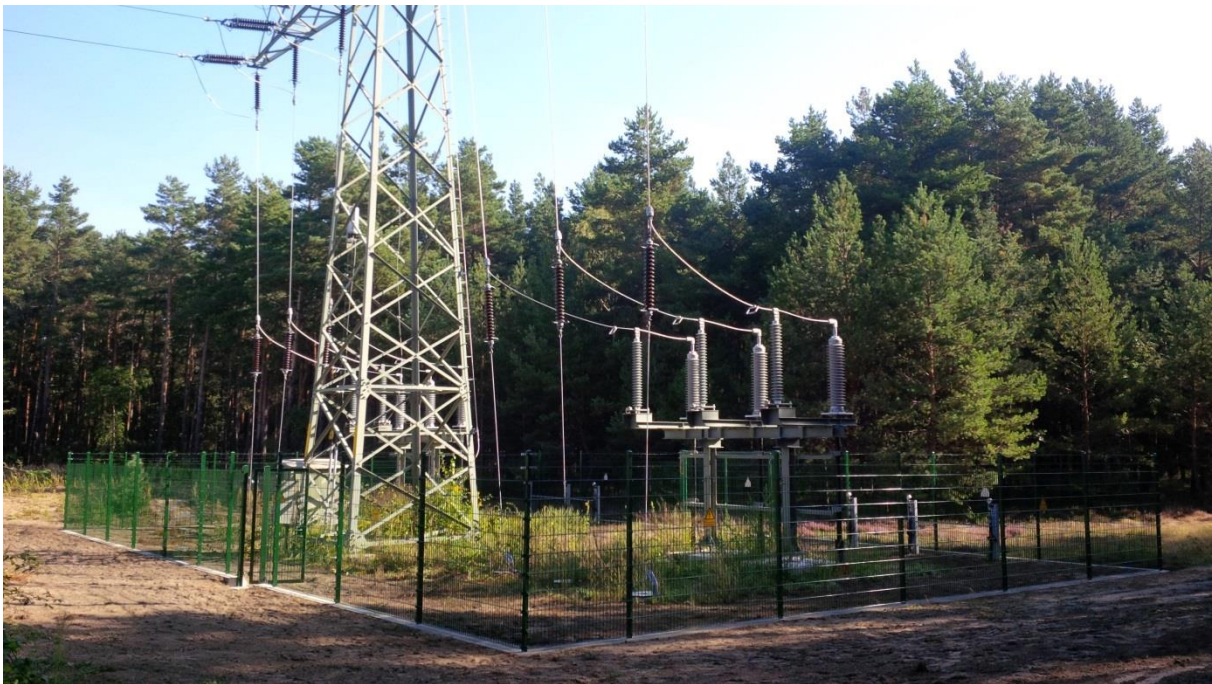
Abbildung 6: 110kV-Kabelendverschlüsse mit Überspannungsableiter auf Endverschlussgerüst
