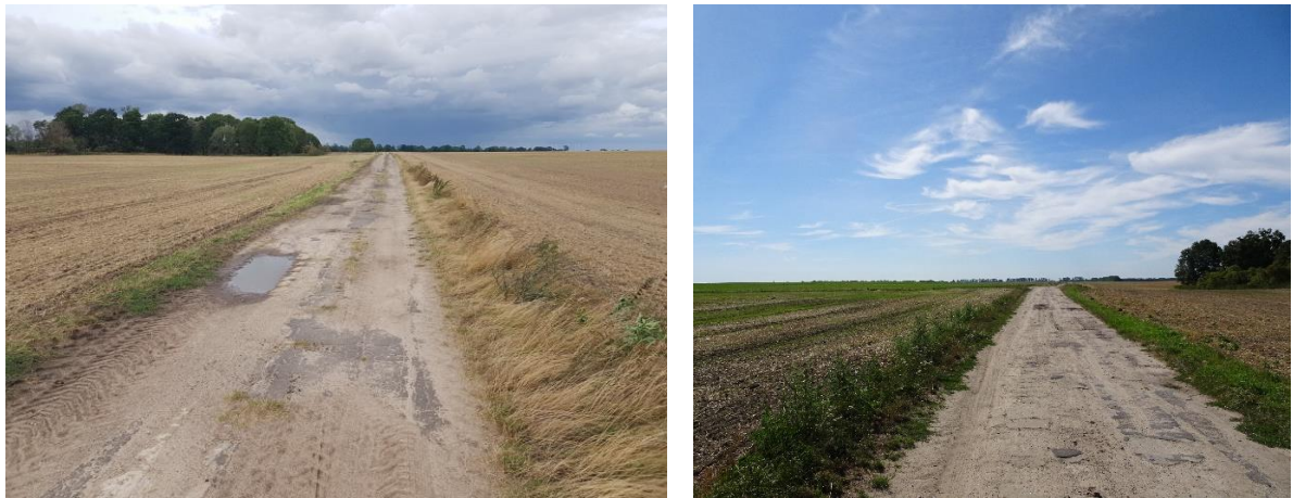
Abbildung 5: Geplante dauerhafte Zufahrten auf Biotoptyp ID-Nr. 11a, Reste von Betonplatten
