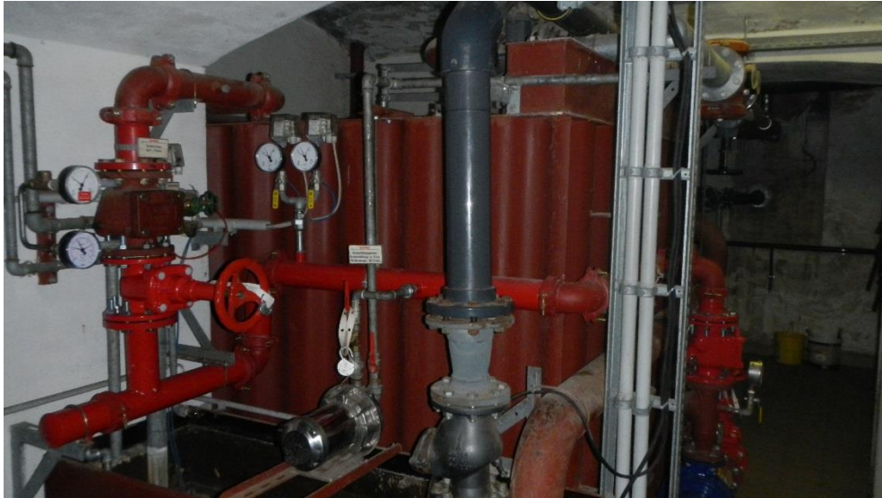
Abbildung 33 Anlagen im Keller
