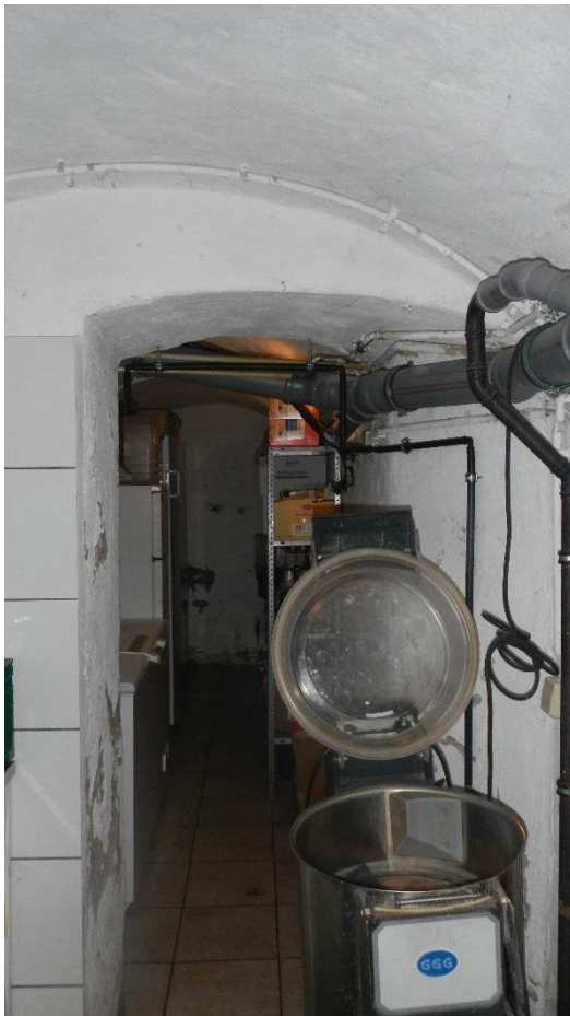
Abbildung 16 Kellerraum mit durchfeuchteten Wänden
