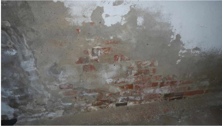
Abbildung 6 Beispiele für durchfeuchtetes Kellermauerwerk
