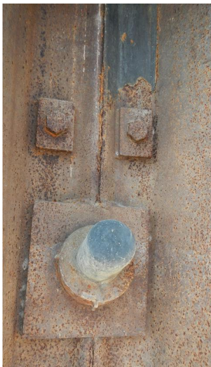
Bild 2 Korrosion an Ankerköpfen
