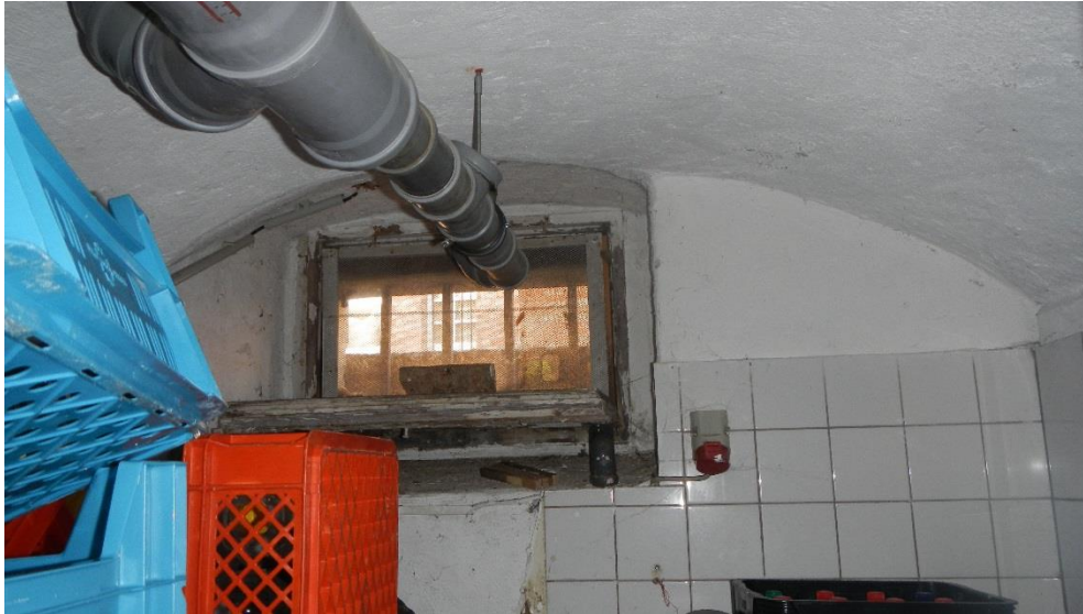
Abbildung 15 Nach außen geführte Be- und Entlüftung
