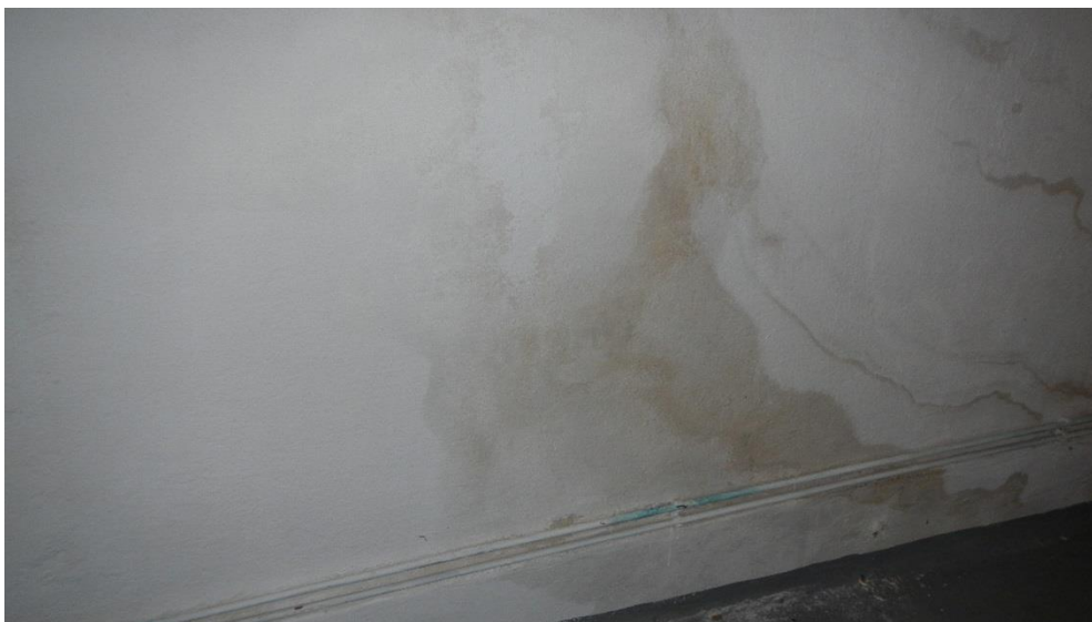
Abbildung 8 Kellerwand mit Durchfeuchtung
