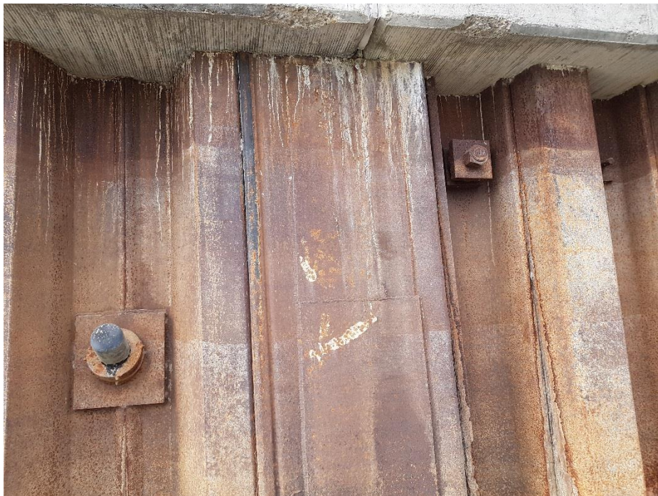
Bild 36 Stark korrodierte Ankerköpfe, teilw. Austritt von Dichtmittel
