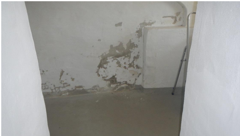
Abbildung 36 Durchfeuchtete Kellerwände Gedenkstätte
