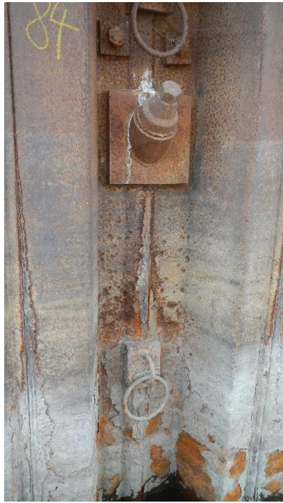
Bild 11 Messpunkt 84 Korrosion Spundwand/Ankerkopf
