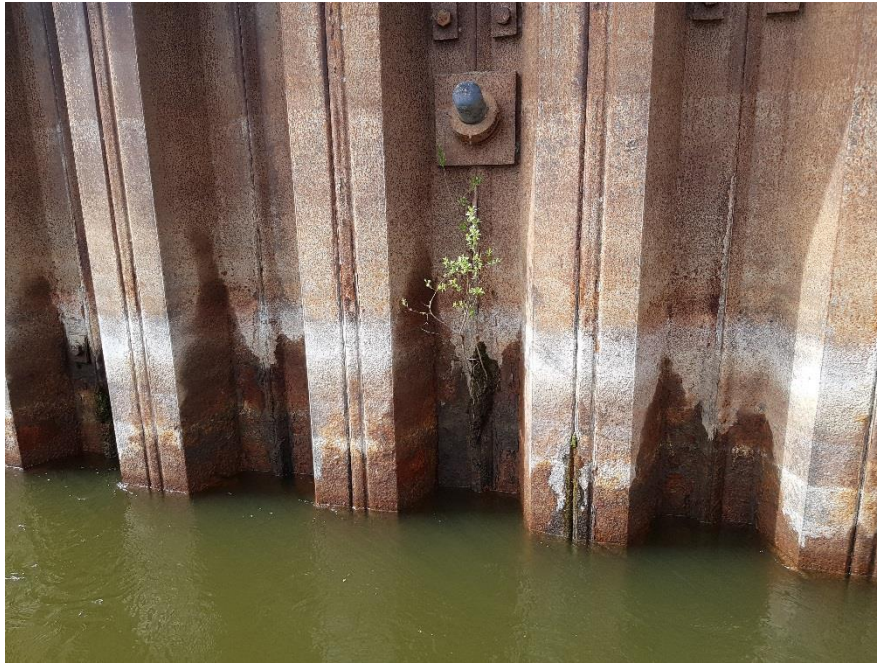
Bild 37 Bewuchs durch Durchrostungsstelle
