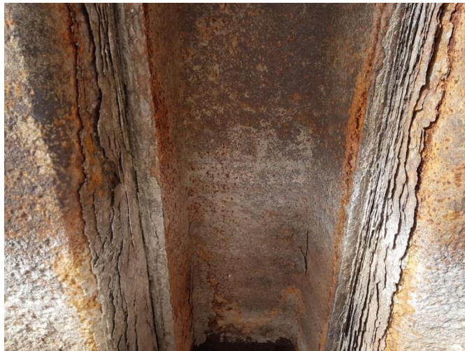
Abbildung 2: Spundwand, großflächige Abplatzungen
