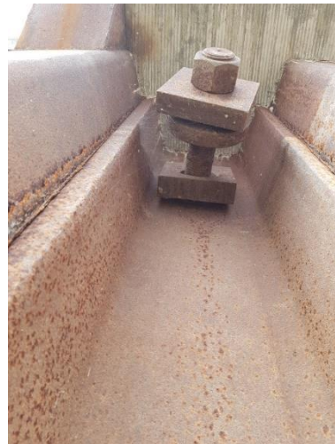
Abbildung 3: Spundwand, herunterhängende, vermutlich gelöste Ankerköpfe
