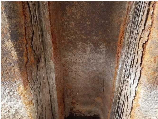
Abbildung 2: Spundwand, großflächige Abplatzungen
