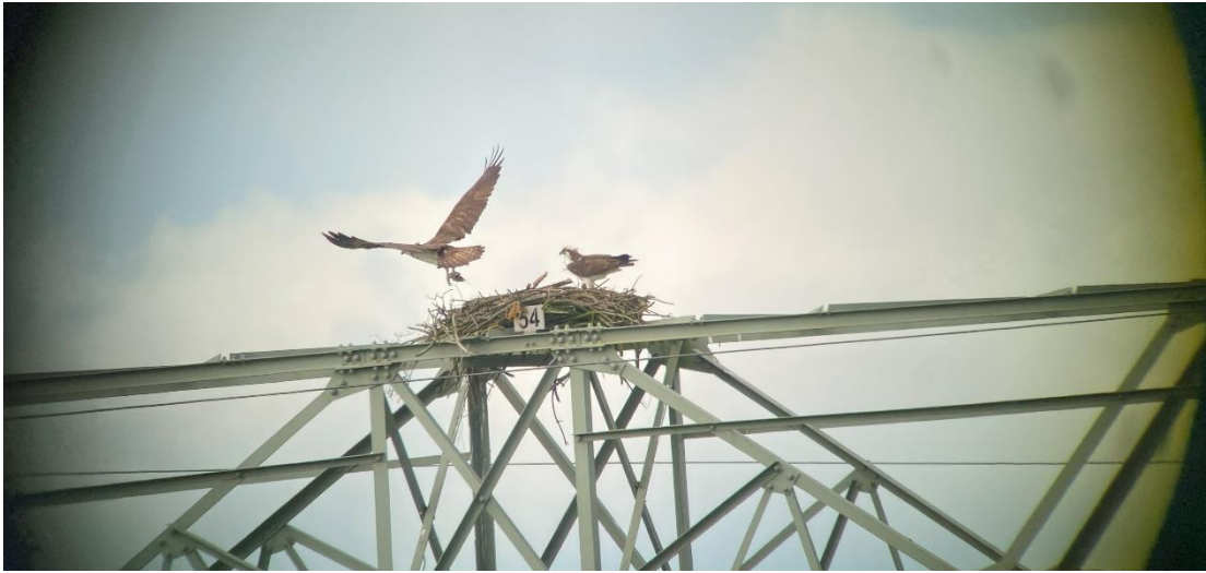
Abbildung 2: Fischadlerpaar mit Nahrung am Umspannwerk (24.04.2023)
