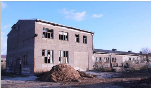
Abb. 14: Das Gebäude ist komplett offen (Fenster) und weist keine zugluftfreien und frostsicheren Bereiche auf. Somit sind höchstens Einzelindividuen der Fledermäuse und Avifauna als Sommergäste zu erwarten.
