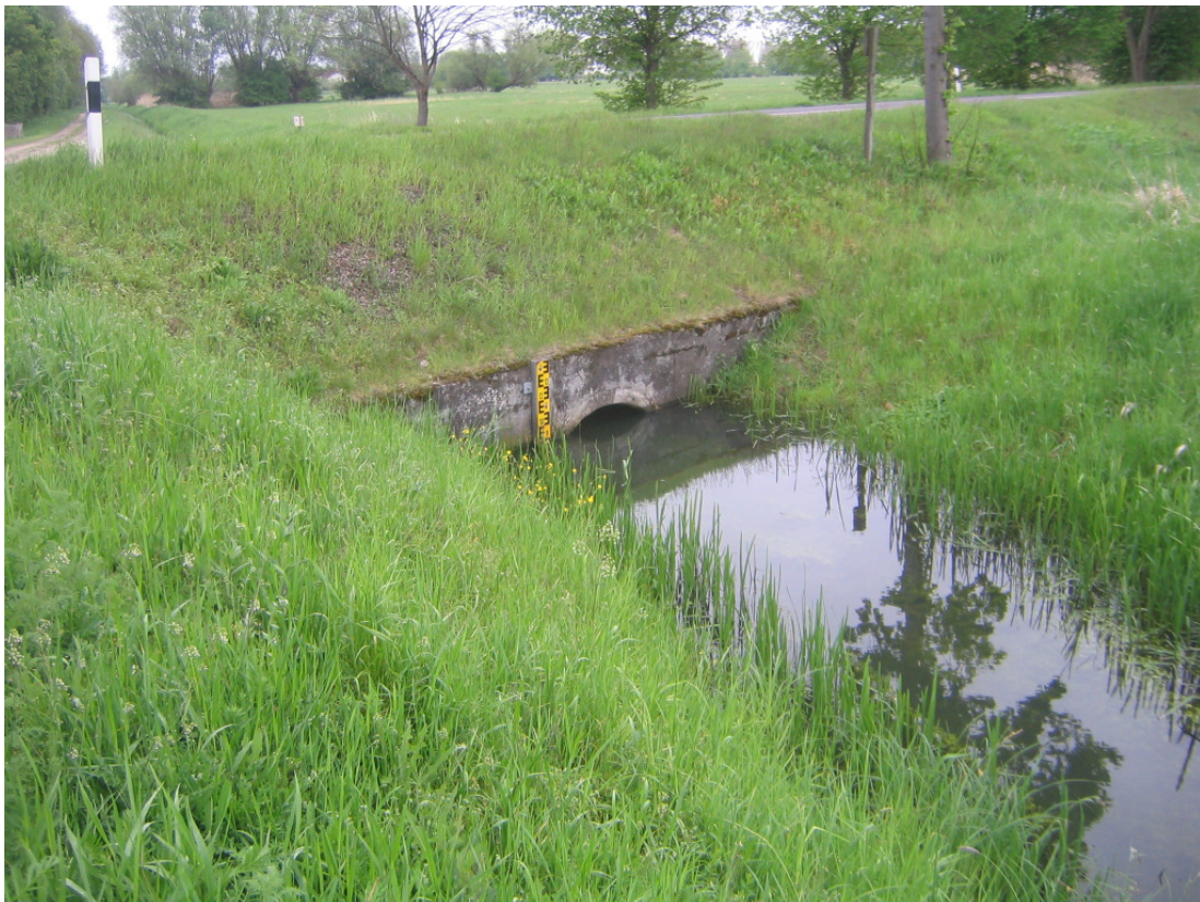
Foto 4: WHAG, Lattenpegel an der B 189 (15.05.2010). Durch den Rückstau am Wehr ist der Graben bis Oberkante Durchlauf angestiegen (Wasserspiegel 18,88 m NN)
