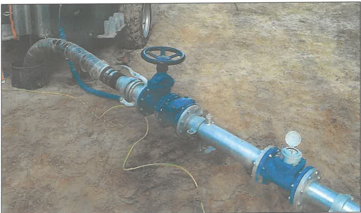
Abb.4 Pumpversuchsanlage mit Pumpenleitung und installiertem Wasserzähler
