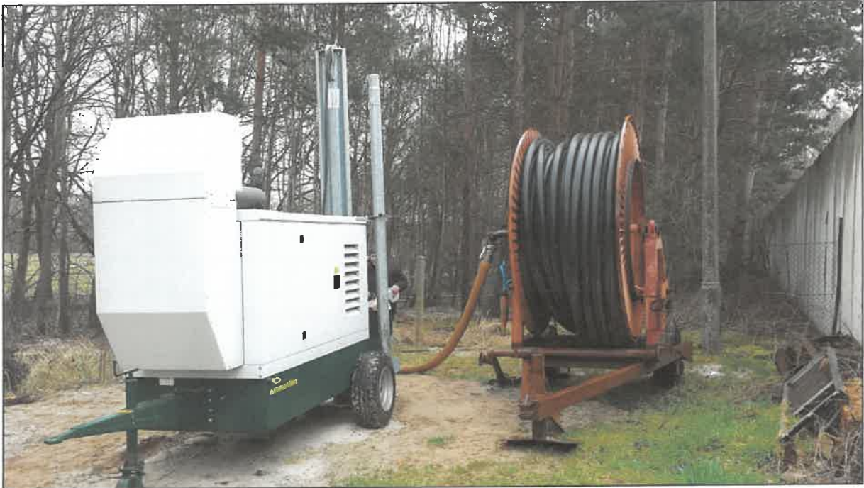
Abb.3 Dieselpumpaggregat am Brunnen während des Pumpversuchs im März 2016- Blick nach Südosten
