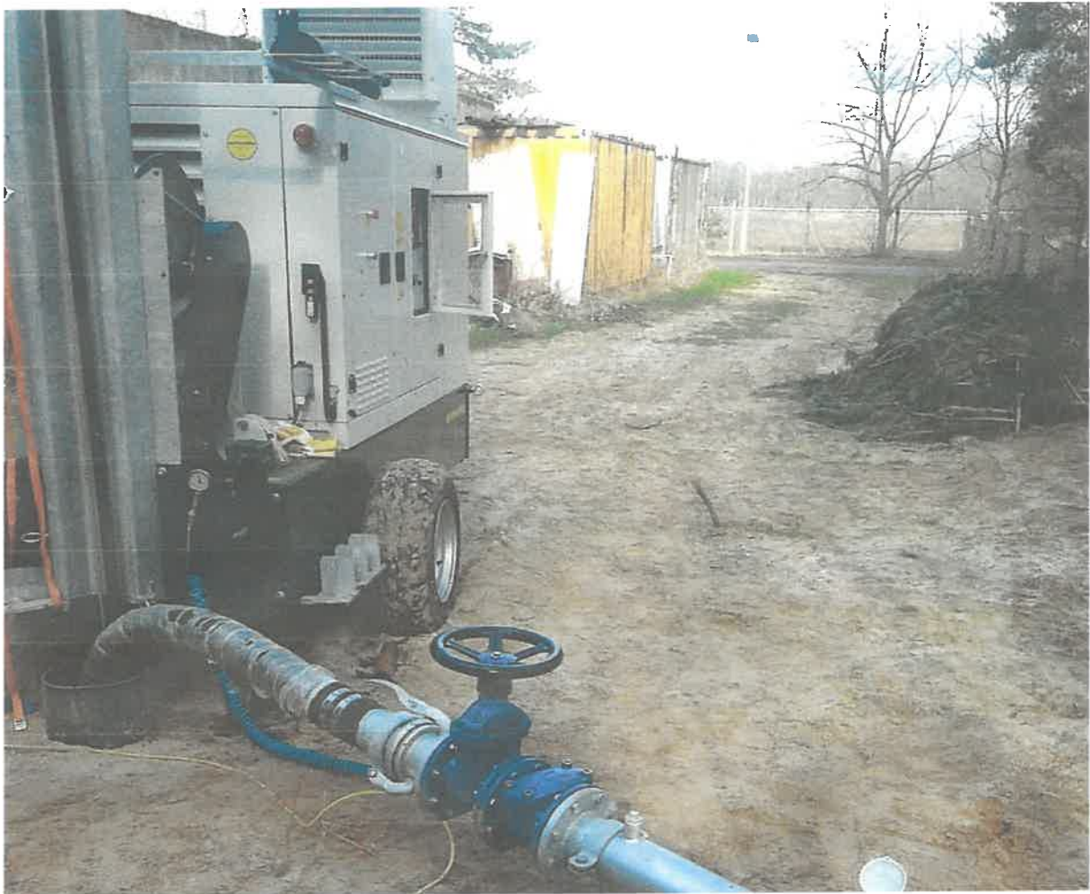
Abb.5 Brunnen RB 2/15 mit Pumpversuchsanlage an der Siloplatte Stücken – Blick nach Nordwesten
