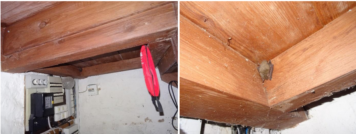
Abb. 23a und 23b: Nutzung der Dorfkirche Werder durch Plecotus sp. (Langohrfledermäuse) als Winterquartier.
